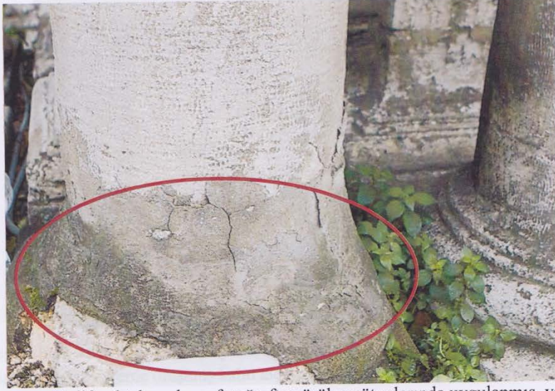
Yapının muhtelif noktalarında ve fotoğrafta görülen sütunlarında uygulanmış, yapıdan uzaklaştırılması gerekli olan niteliksiz onarımların görünümü
