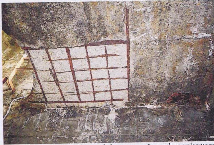
Yapının döşeme/tavanlarında ileri derecede korozyona uğrayarak parçalanmasına neden olan donatıların görünümü
