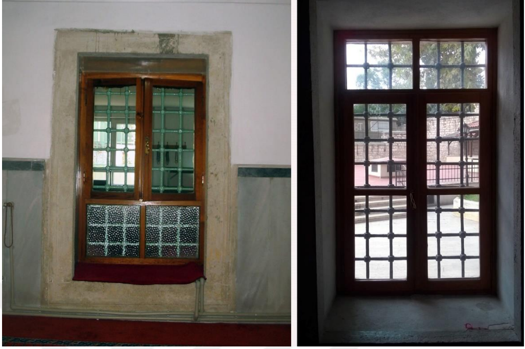
Şekil 5.35 : Sinan Paşa Camisi alt pencere içi uygulama öncesi ve sonrası durumu (Ö.E.a.).
