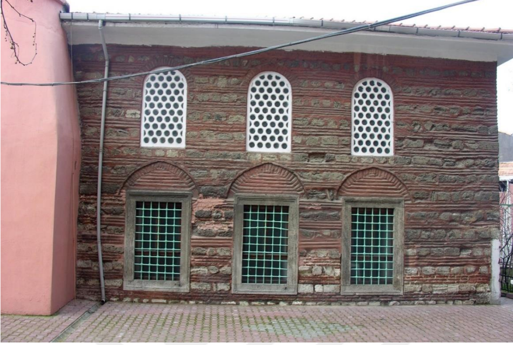
Şekil 5.53 : Sinan Paşa Camisi cephesi uygulama öncesi durumu (Ö.E.a.).
