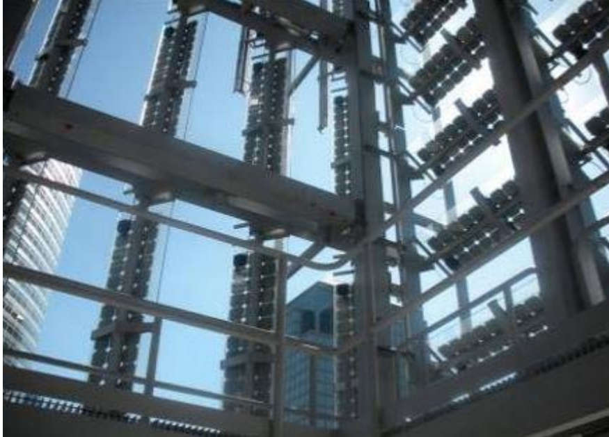
Şekil 4.6 River House güneşe uyarlabilir fotovoltaik sistemi (Medio, 2013).
