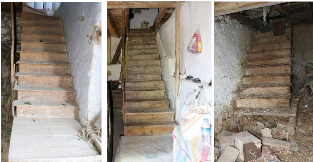
Şekil 3.42 : (Solda) 101 ada, 246 parselde ve (Ortada) 101 ada, 244 parselde ve (Sağda) 123 ada, 100 parselde zemin kat ile birinci kat arasında bulunan merdivenler (Turğut, 2018).
