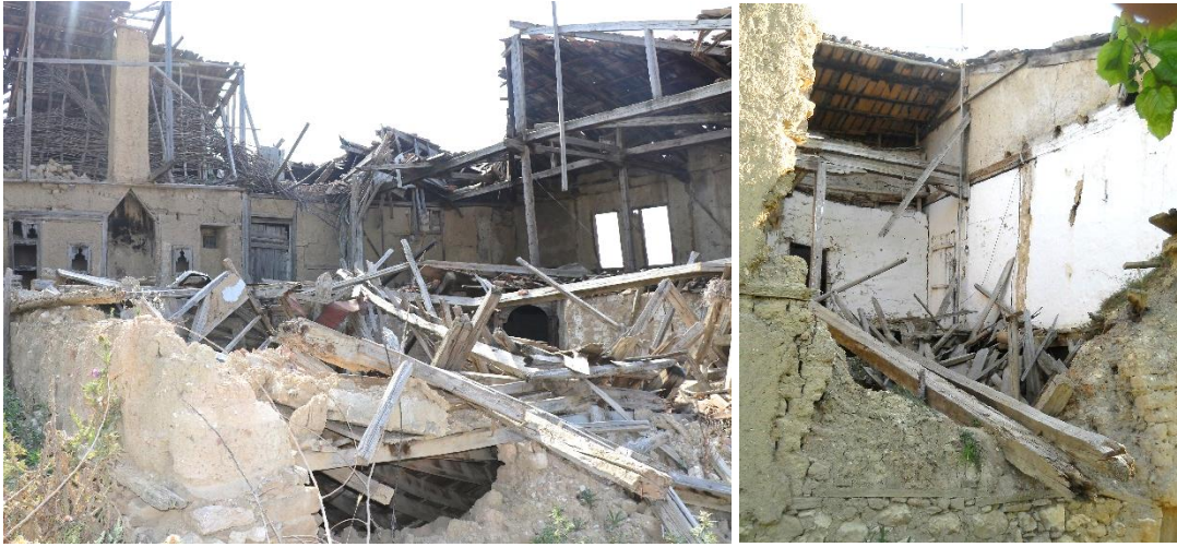
Şekil 4.4 : (Solda) 101 ada, 192 parsel (Sağda) 127 ada, 25 parselde terk ve bakımsızlık sebebiyle bozulmaya uğrayan yapılar (Turğut, 2018).
