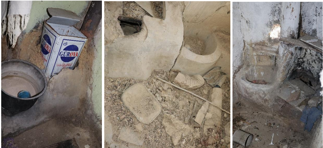
Şekil 3.50 : (Solda) 101 ada, 244 parsel, (Ortada) 101 ada, 246 parsel ve (Sağda) 123 ada, 102 parselde bulunan gusülhanelerin iç görünüşleri (Turğut, 2018).
