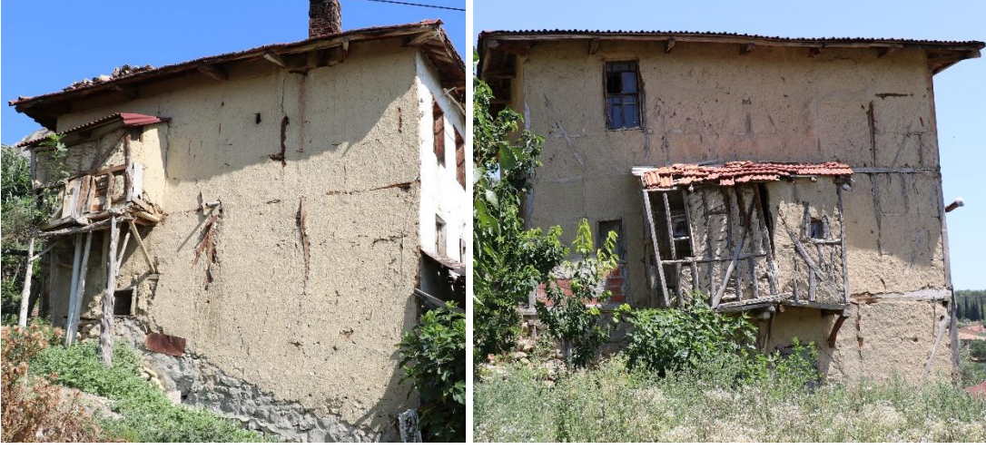
Şekil 3.59 : (Solda) 101 ada, 244 parsel ve (Sağda) 101 ada, 246 parselde bulunan konutların hela ekleri (Turğut, 2018).
