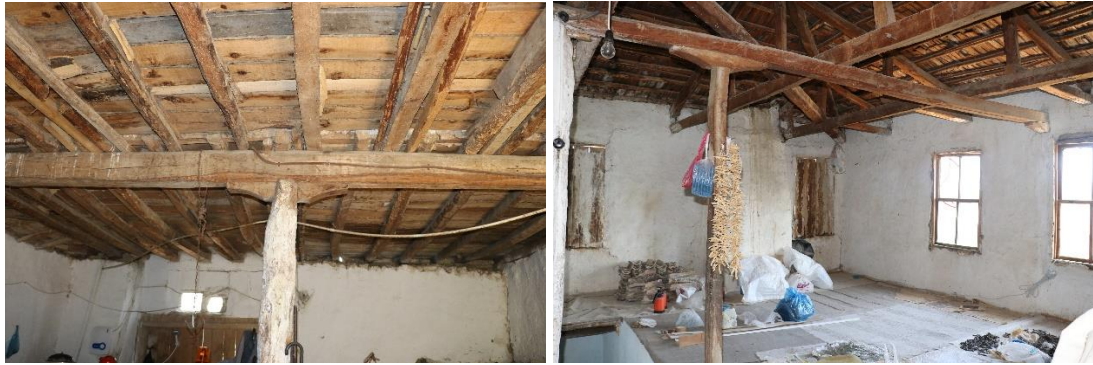
Şekil 3.90 : (Solda) 101 ada, 244 parselde üst kat kirişlerini ve (Sağda) 127 ada, 21-22 parselde çatı kirişlerini taşıyan başlıklı ahşap dikmeler (Turğut, 2018).
