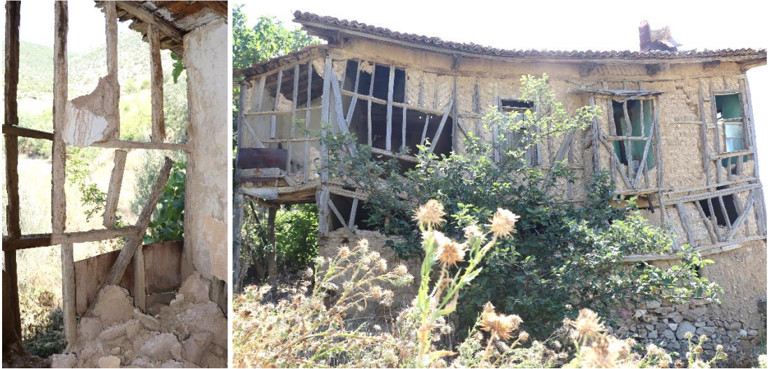
Şekil 4.3 : 101 ada, 225 parselde mukavemeti azalan ve sehim yapan ahşap malzemeler (Turğut, 2018).
