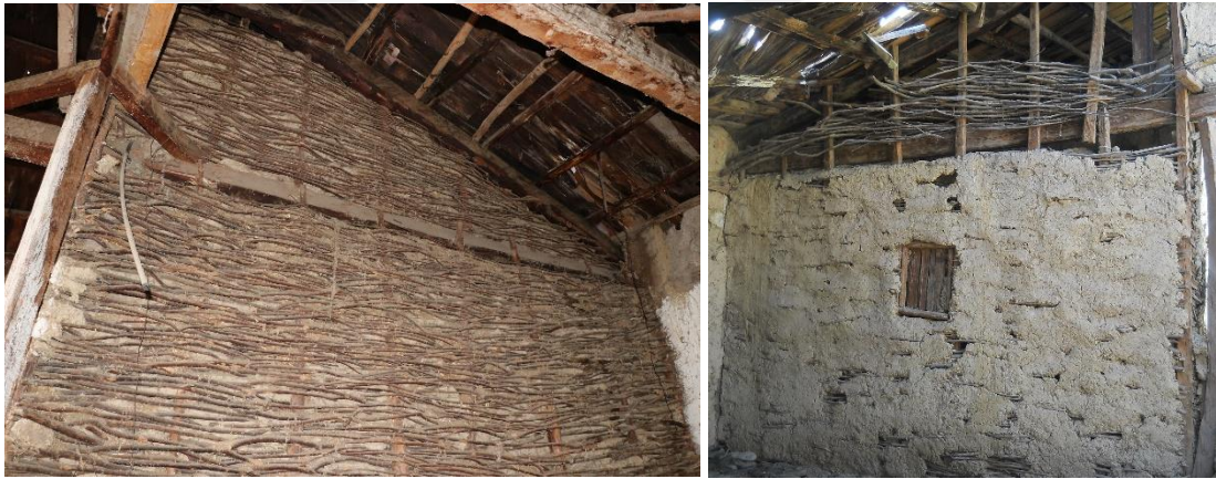
Şekil 3.92 : (Solda) 124 ada,28 parselde görülen sıvasız ve (Sağda) 127 ada, 25 parselde görülen sıvalı dal örgü (Turğut, 2018).
