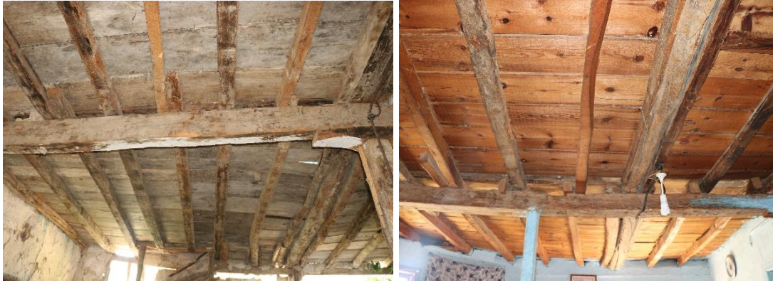
Şekil 3.94 : (Solda) 101 ada,225 parselde ve (Sağda) 130 ada, 2 parselde bulunan konutların döşeme kirişleri (Turğut, 2018).
