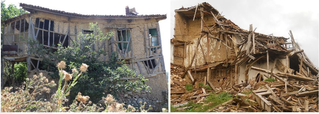
Şekil 4.22 : (Solda) 101 ada, 225 parselde sehim yapan (Sağda) 129 ada, 4 parselde taşıyıcı sistemi kalmayıp çöken konut (Turğut, 2018).
