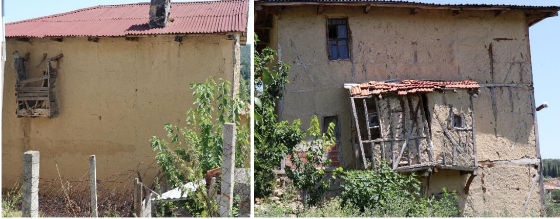
Şekil 4.24 : (Solda) 130 ada, 2 parseldeki konutta ve (Sağda) 101 ada, 246 parseldeki konutta kullanılmayan ve sehim yapan hela-gusülhane çıkmaları (Turgüt, 2018).
