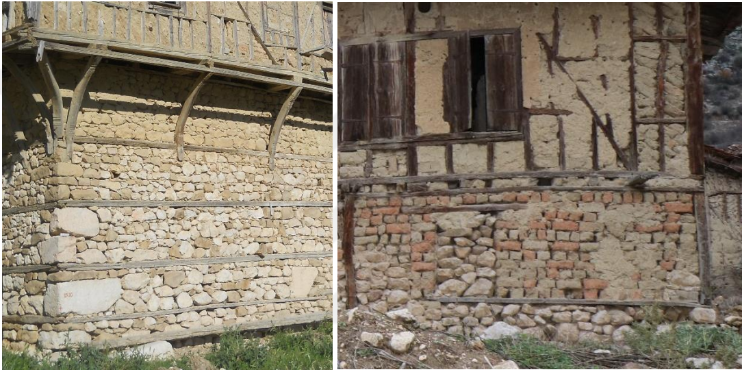
Şekil 3.88 : (Solda) 127 ada, 26 parsel ve (Sağda) 127 ada, 25 parseldeki yapıların zemin kat duvarları (Turğut, 2018).
