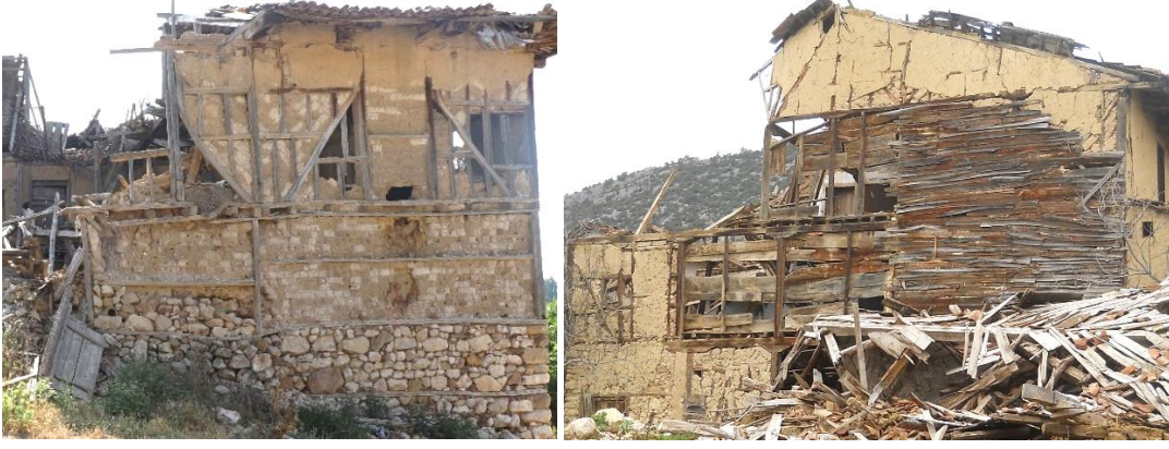
Şekil 4.27 : (Solda) 101 ada, 192 parselde ve (Sağda) 127 ada, 11-12 parselde bulunan konutların yoğun malzeme bozulmaları (Turğut, 2018).
