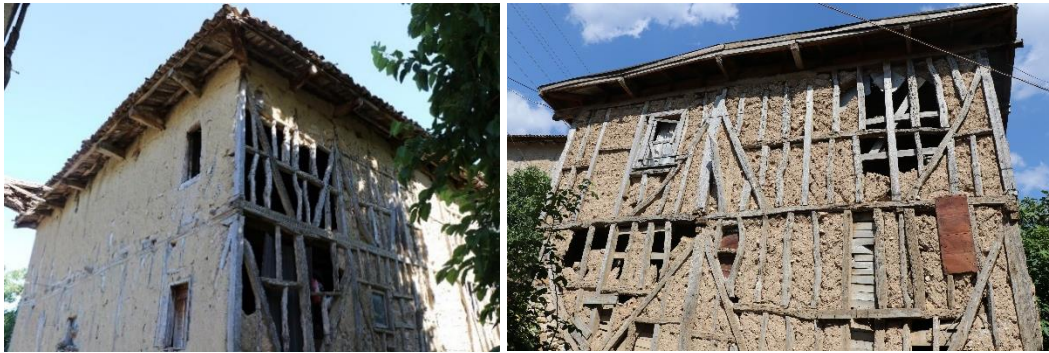
Şekil 4.28 : (Solda) 101 ada, 257 parseldeki ve (Sağda) 123 ada, 35 parseldeki kerpiç malzeme kayıpları (Turğut, 2018).
