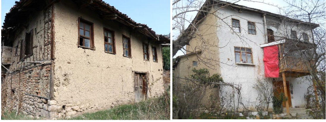
Şekil 3.21 : (Solda) 127 ada, 25 parselde fiziksel özgünlük durumu iyi ve (Sağda) 126 ada,2 parselde fiziksel özgünlük durumu orta olan yapı (Turğüt,2018).
