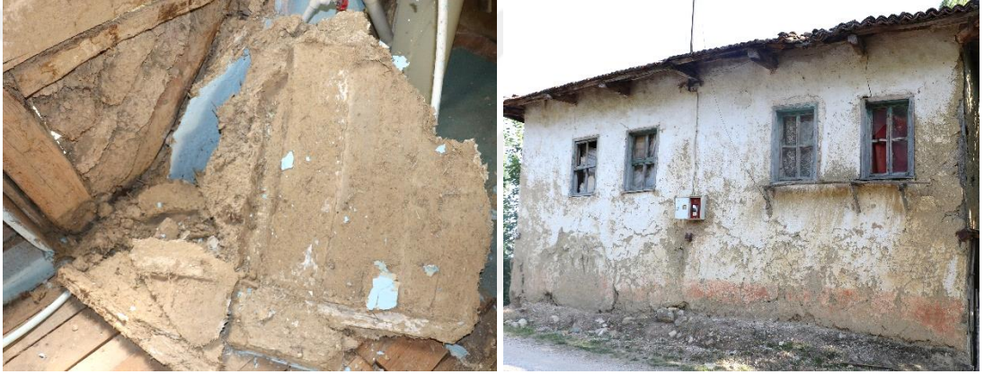
Şekil 3.107 : (Solda) 123 ada, 35 parselde duvardan ayrılmış çamur sıva ve (Sağda) 123 ada, 102 parselde kireç sıvası dökülmeye başlamış duvar (Turğut, 2018).
