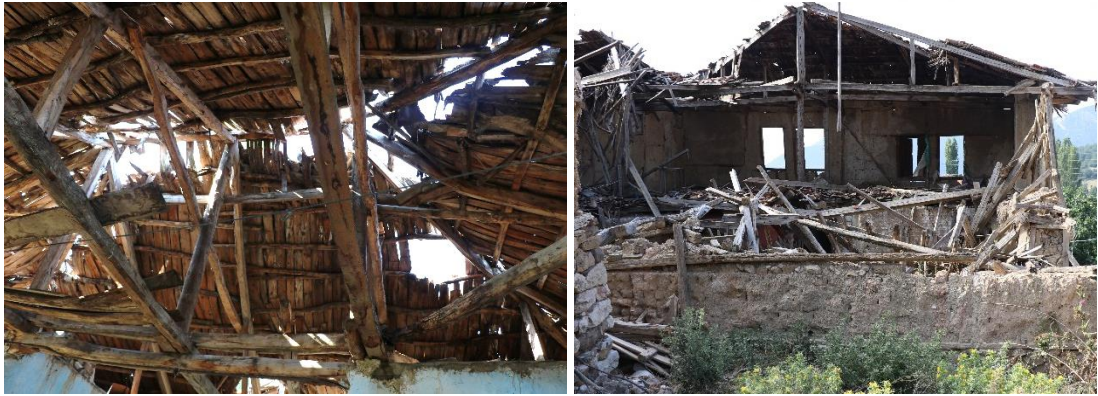
Şekil 4.23 : (Solda) 123 ada, 100 parselde çatısı yıpranan ve (Sağda) 101 ada, 192 parselde çatısı çöken konut (Turğut, 2018).
