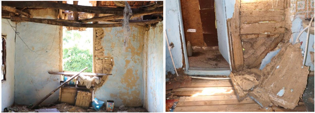
Şekil 4.26 : (Solda) 130 ada, 2 parseldeki ve (Sağda) 123 ada, 35 parseldeki konutta dökülen iç sıvalar (Turğut, 2018).
