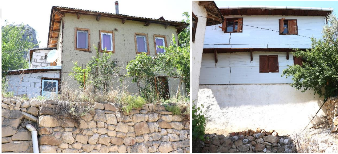
Şekil 4.5 : (Solda) 101 ada, 241 parsel ve (Sağda) 131 ada, 2 parselde konutlara yapılan bilinçsiz müdahaleler (Turgut, 2018).
