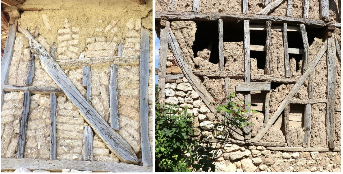
Şekil 4.2 : (Solda) 123 ada, 33 parsel ve (Sağda) 123 ada, 35 parselde iklimsel etkenlerle bozulmaya uğrayan ahşap ve kerpiç malzemeler (Turğut, 2018).
