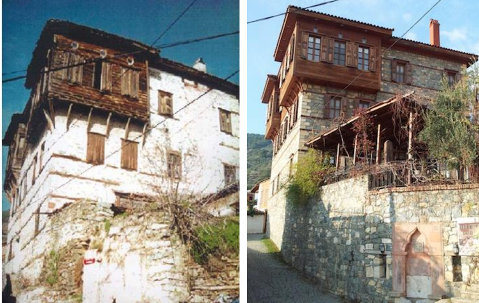
Resim B.1 Çeşmeli Konak – Restorasyon Öncesi ve Sonrası Cephe Görünüşü (Soldaki Fotoğraf Tufan Atalayman Fotoğraf Arşivi, Sağdaki Fotoğraf Nihan Polatdemir Fotoğraf Arşivi)
