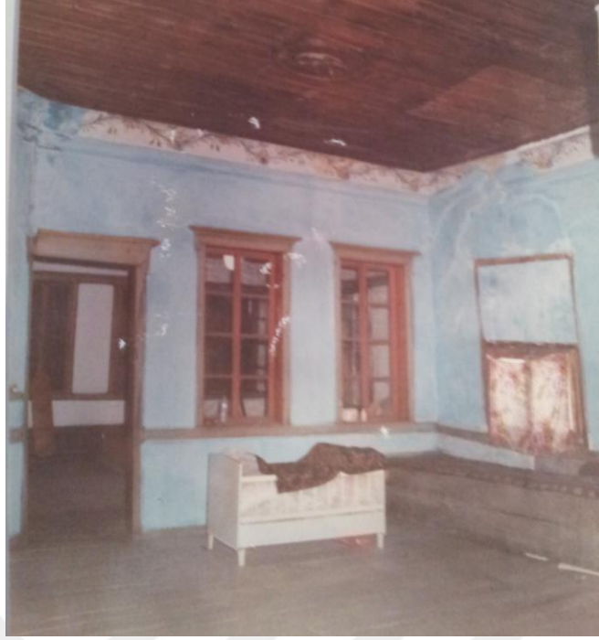
Resim B.10 Çeşmeli Konak – Restorasyon öncesi bir sofaya açıldığı düşünülen oda pencereleri, oda tavanı ve yer döşemesi (Tufan Atalayman Fotoğraf Arşivi)
