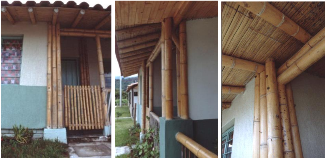
Resim 18. Kolombiya'da çağdaş çimento bahareque ile yapılmış konut temel ve dikmeleri detayları (Muñoz, 2002)
