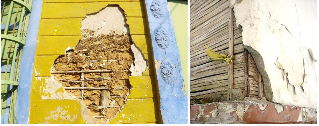
Resim 38. Duvar sıvasının tahribatı (Patrimonio escondido, 2017; Galindo, 2011)
