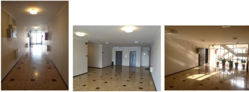
Şekil 4.22 Hukukçular Sitesi- Kat arası ve Koridorlarda Sirkülasyon Alanlarının Genişliği (Fotoğraflar: Melike Yenice)
