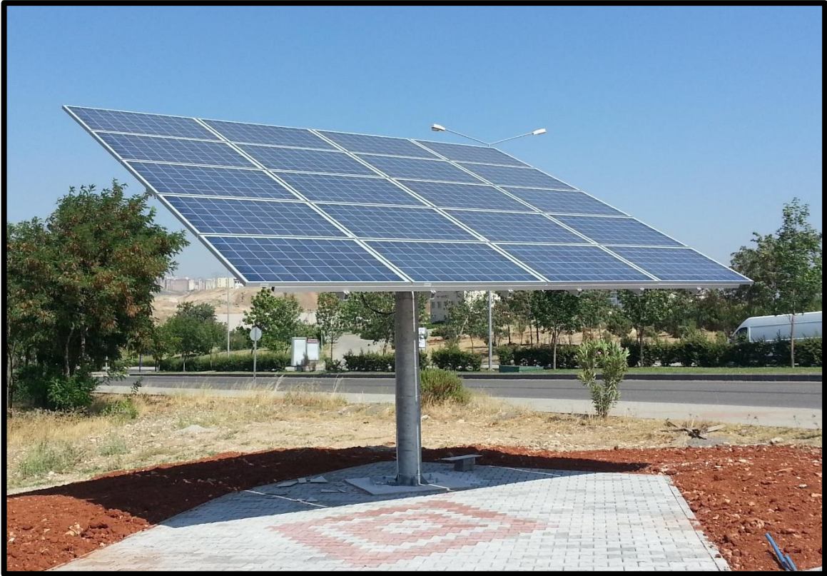
Şekil 4-46. Güneş takip sistemi
