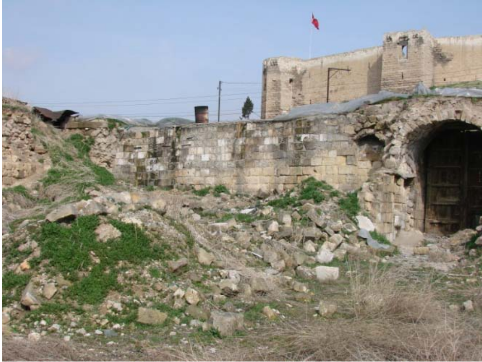
Şekil 4.4 Gaziantep Kalesi ve Restorasyon Öncesi Hışvahan
