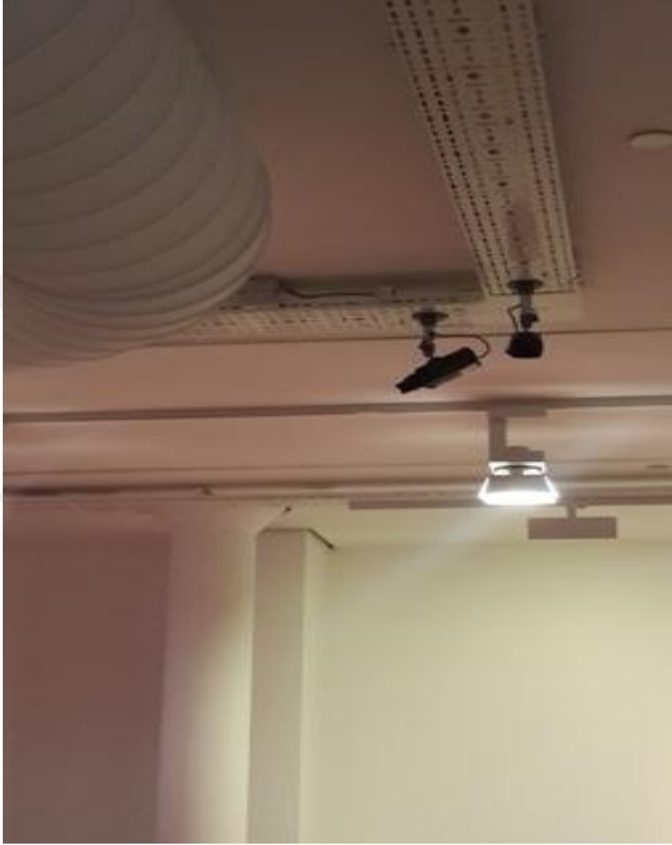
Şekil 3.77: Arter Binası Sergi Salonu kutu kanal(SA)
