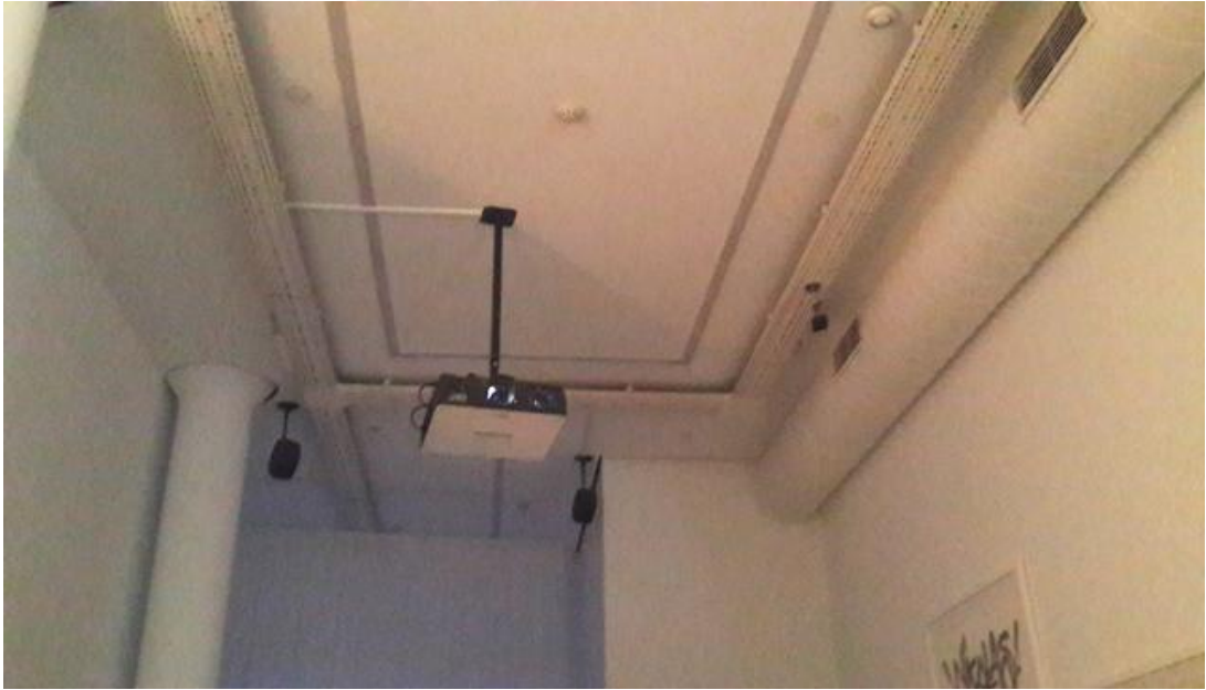
Şekil 3.72: Arter sergi salonu havalandırma kanalı(SA)
