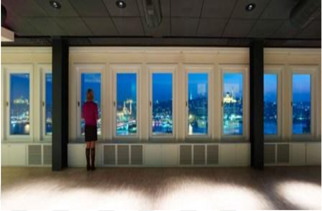
Şekil 3.71: Salt Galata binası iç mekân pencere önü gizli kalorifer petekleri (HT arşivi)
