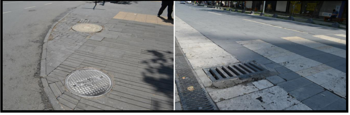
Şekil 4. 24. Trabzon Caddesinde yaya ve araç geçişlerinde sorun olabilecek bakım kapakları
