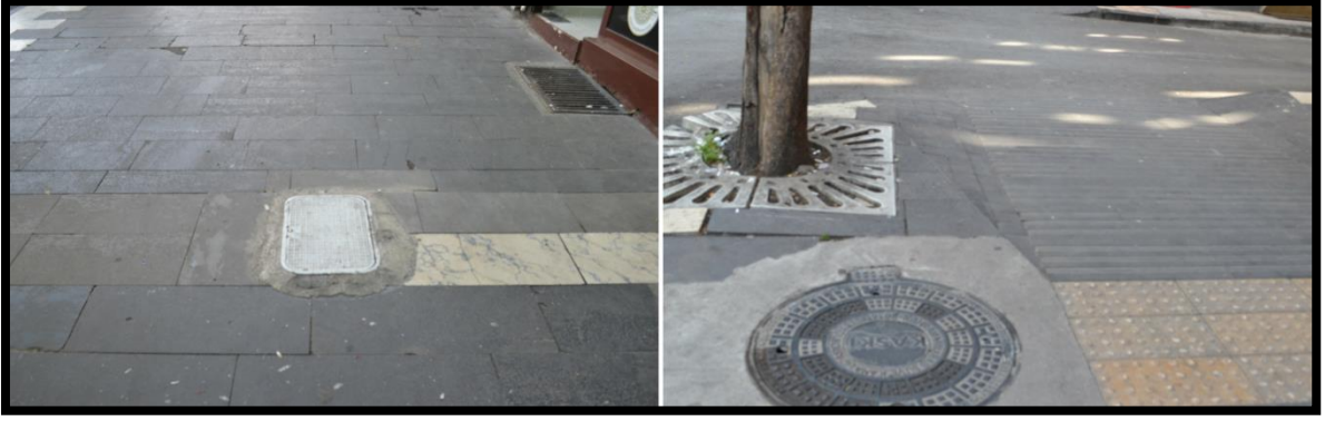
Şekil 4. 27. Hükümet Caddesinde kot farkı olan bakım kapakları
