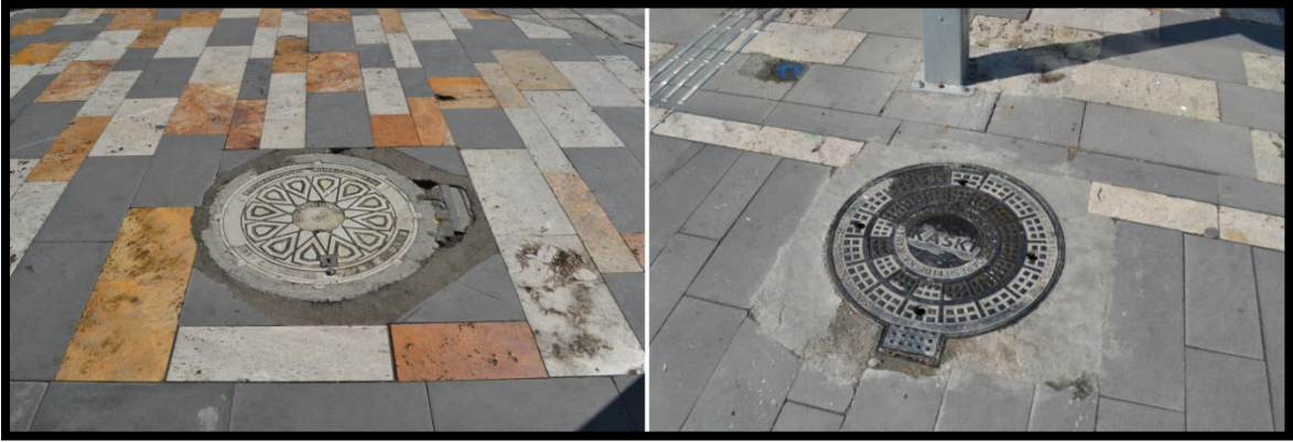
Şekil 4. 23. Trabzon Caddesinde yer alan bakım kapakları
