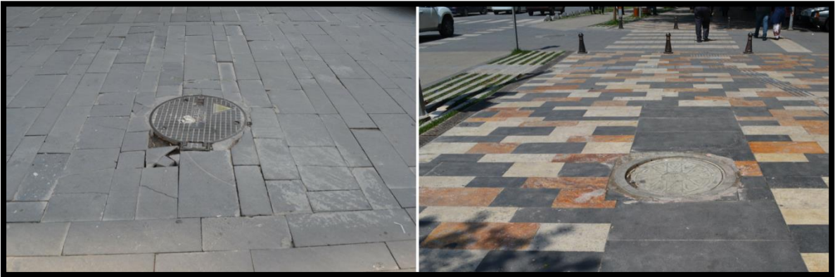
Şekil 4. 26. Trabzon Caddesinde kot farkı olan bakım kapakları
