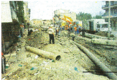
Foto-11 Su borularında hasar
