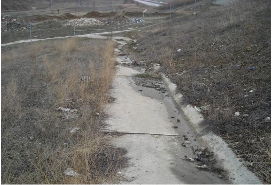
Şekil 3.8- 3.9: Beton Hendek ve Şevden Selle Gelen Yüzeyin Tıkanmalara Yol Açması
