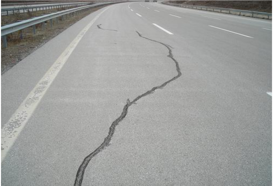
Şekil 3.11- 3.12: Boyuna Çatlak Oluşumu ve Tamirinde Faydasız Kalınması
