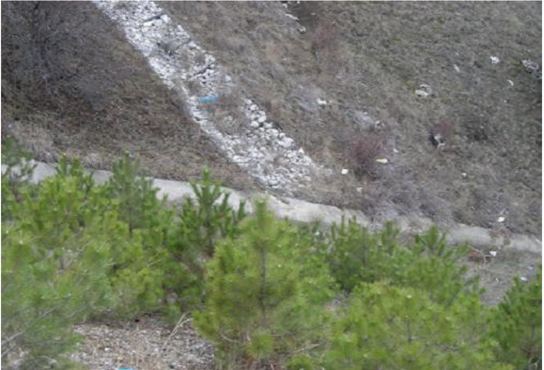
Şekil 3.2: Hendeklerdeki Küplü Enerji Kırıcılar
