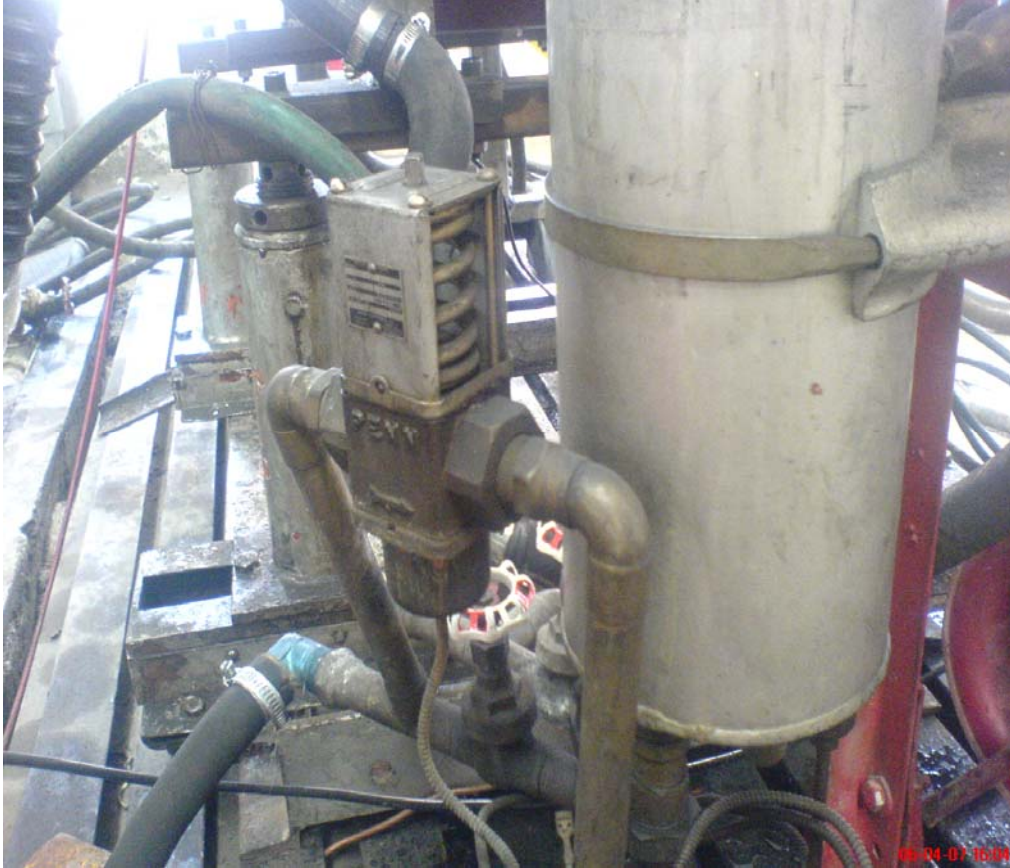
Şekil 2.5. Soğutma Kulesi Genel Görünümü
