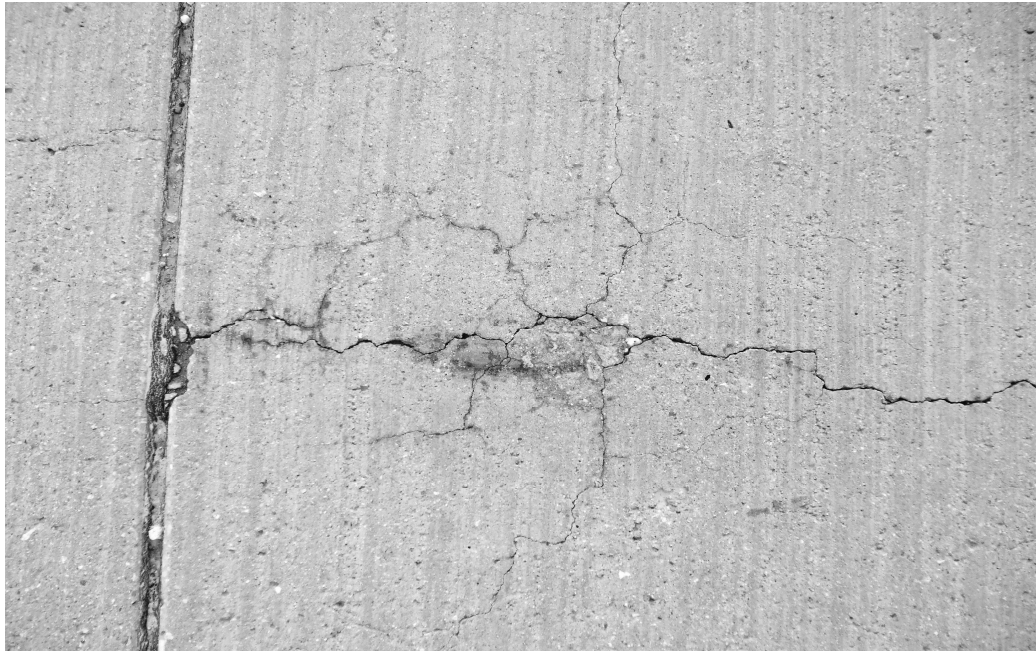
Şekil 2.11. Afyon'da ki Beton Yoldan ASR'ye İlişkin Çatlak Görünümü (29)
