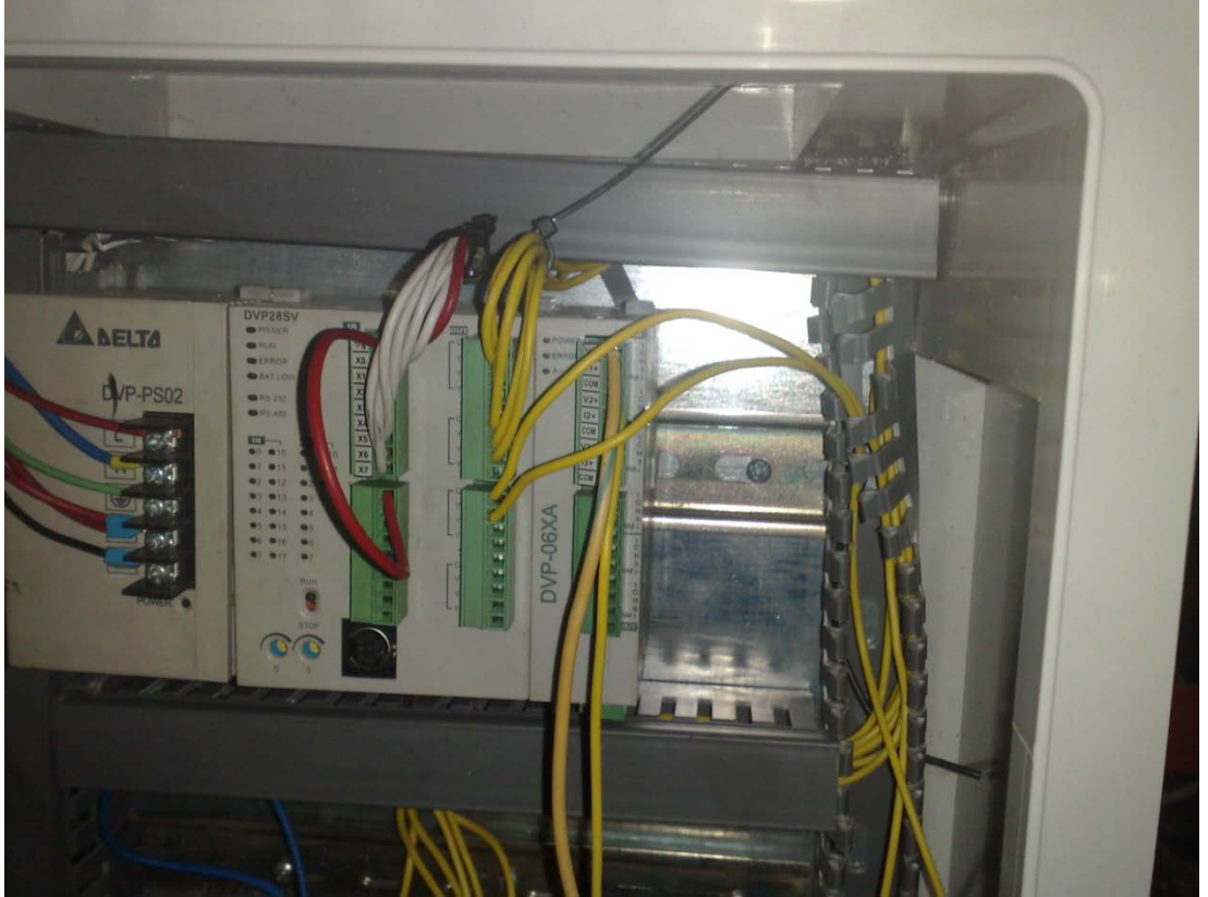
Şekil 2.9 Elektrik Kontrol Panosunun Kapağı Açık, İç Görünüşü.
