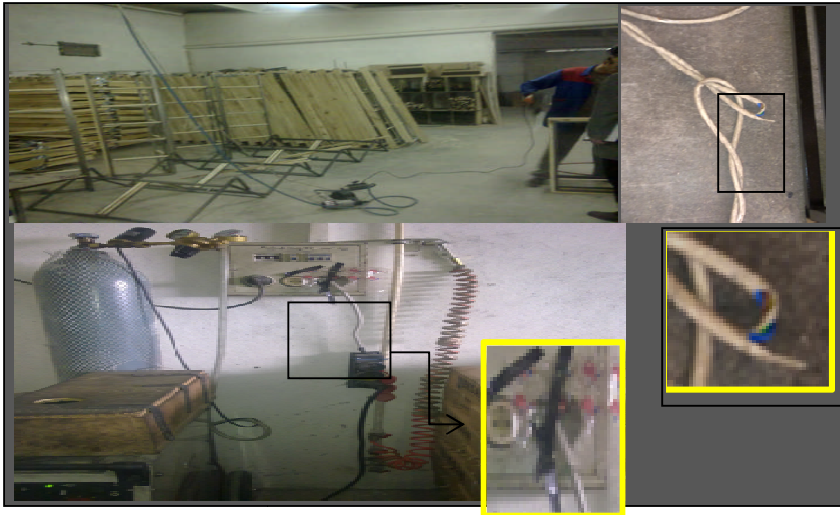
řekil 5.21. Elektrik Baęlantılarının Dzenli Ve Korumalı Olmaması
