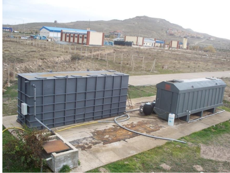
Şekil 2.33. Kurulan atık su arıtma tesisi
