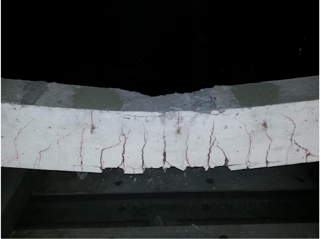
Şekil 2.22. S3G2 elemanında oluşan çatlak gelişimi
