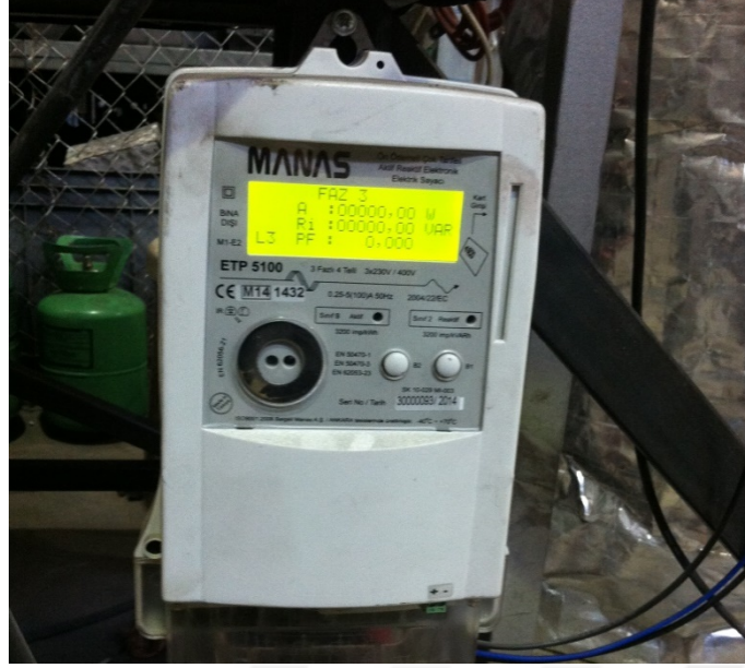
Şekil 4.15. Elektrik sayacının fotoğrafı.
