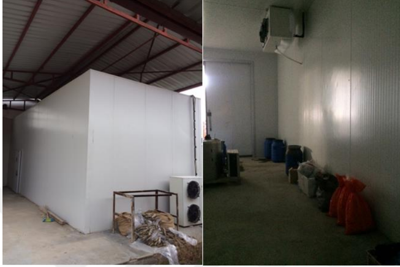
Şekil 3.21. Soğuk hava deposu
