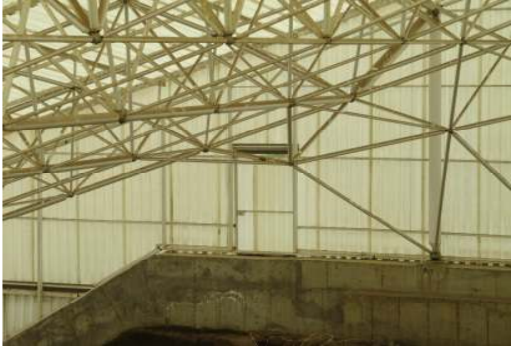
Res. 27b, Çatalhöyük, Güney Alanı Koruma Çatısı Betonarme Temeller (Müge Savrum Arşivi 2010)
