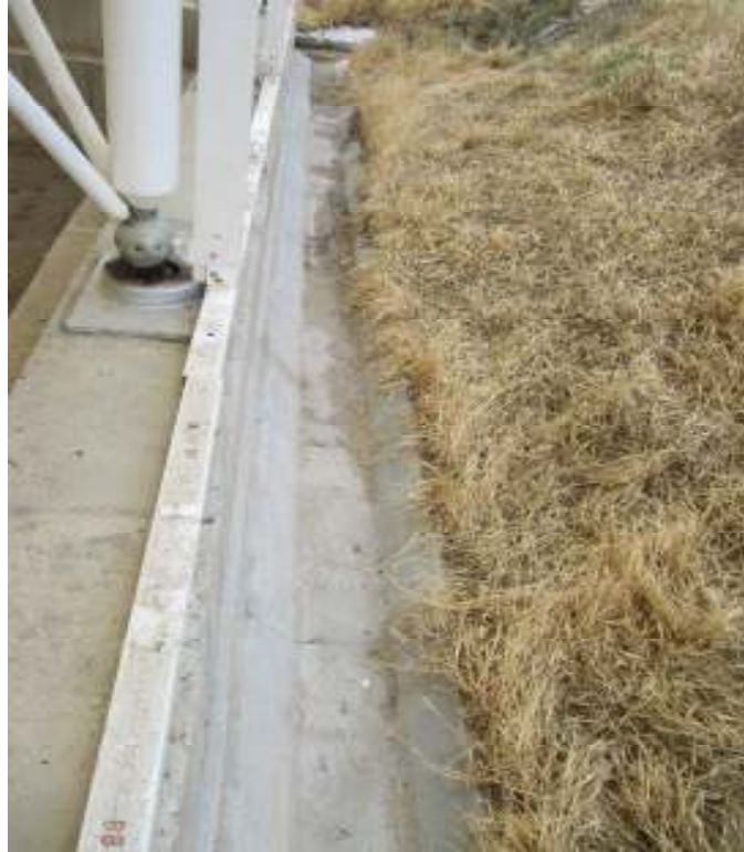
Res. 25, Çatalhöyük, Güney Alanı Koruma Çatısı Drenaj Sistemi (Müge Savrum Arşivi 2010)
