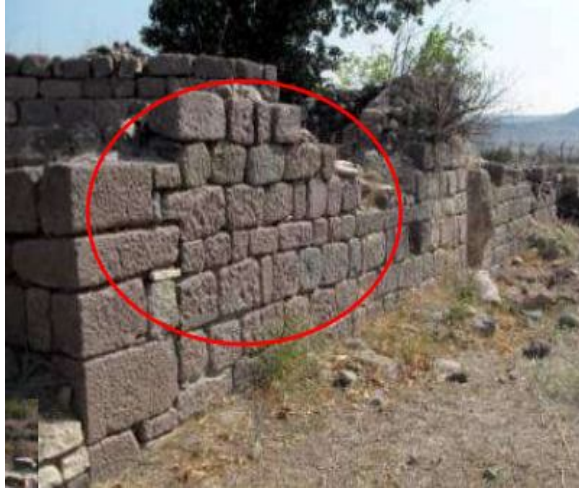
Fotoğraf 174. Derz Onarımı, Uygulama Öncesi (Arısoy, vd., 2010: 54)
