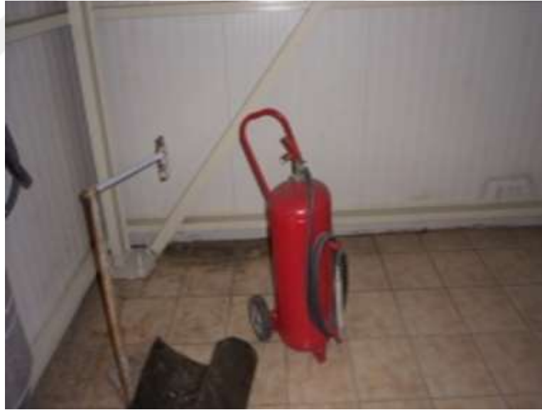
Şekil 3.4 (2019) : Yangın tüpünün yerinin değiştirilmesi.
