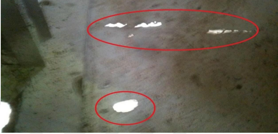
Şekil 4.13 : Santral mikser alanında deformasyona uğramış zemin.
