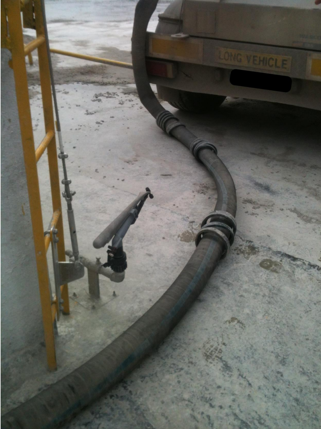
Şekil 4.19 : Çimento silobasından tesis çimento silolarına aktarım hortumu.
