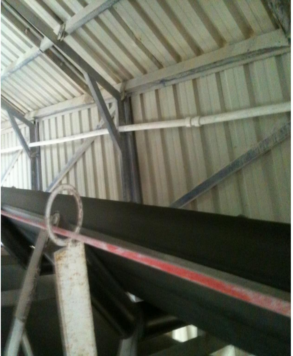
Şekil 4.8 : Agreg taşıma bant bölümü açıkta bulunan hareketli bölüm.
