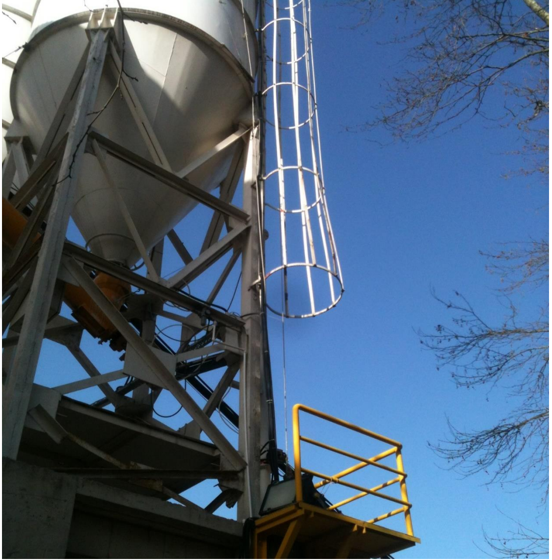
Şekil 4.16 : Kontrollü erişim için kapatılmamış silo gemici merdiveni.
