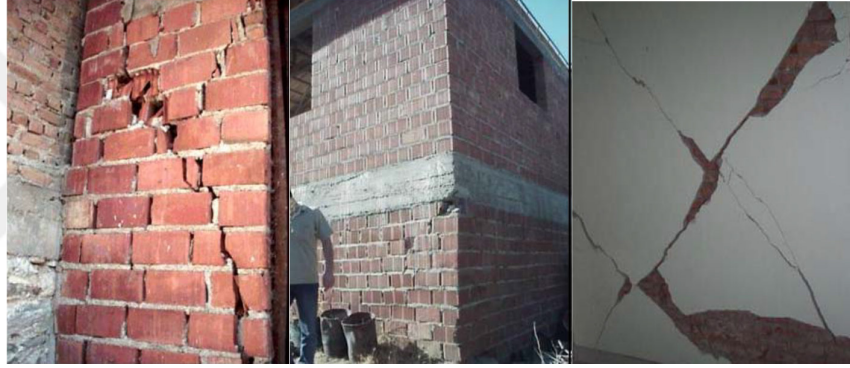
Şekil 3.18. Yığma yapılarda meydana gelen duvarlarda ve duvar köşelerinde oluşan kesme hasarı (Çırak, 2011)
