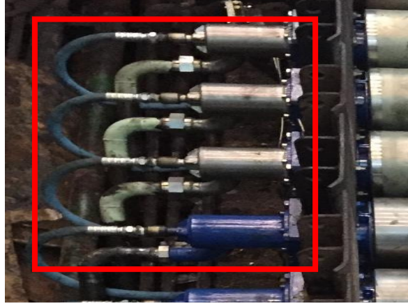
Şekil 1. 13. Duşlu masa rolleri için soğutma sisteminin görünümü
