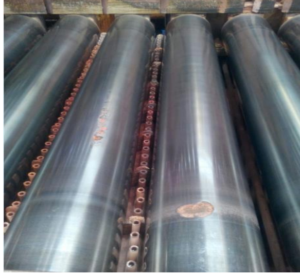
Şekil 1. 9. Duşlu masa rolleri yüzeyindeki alev spray kaplama kusuru
