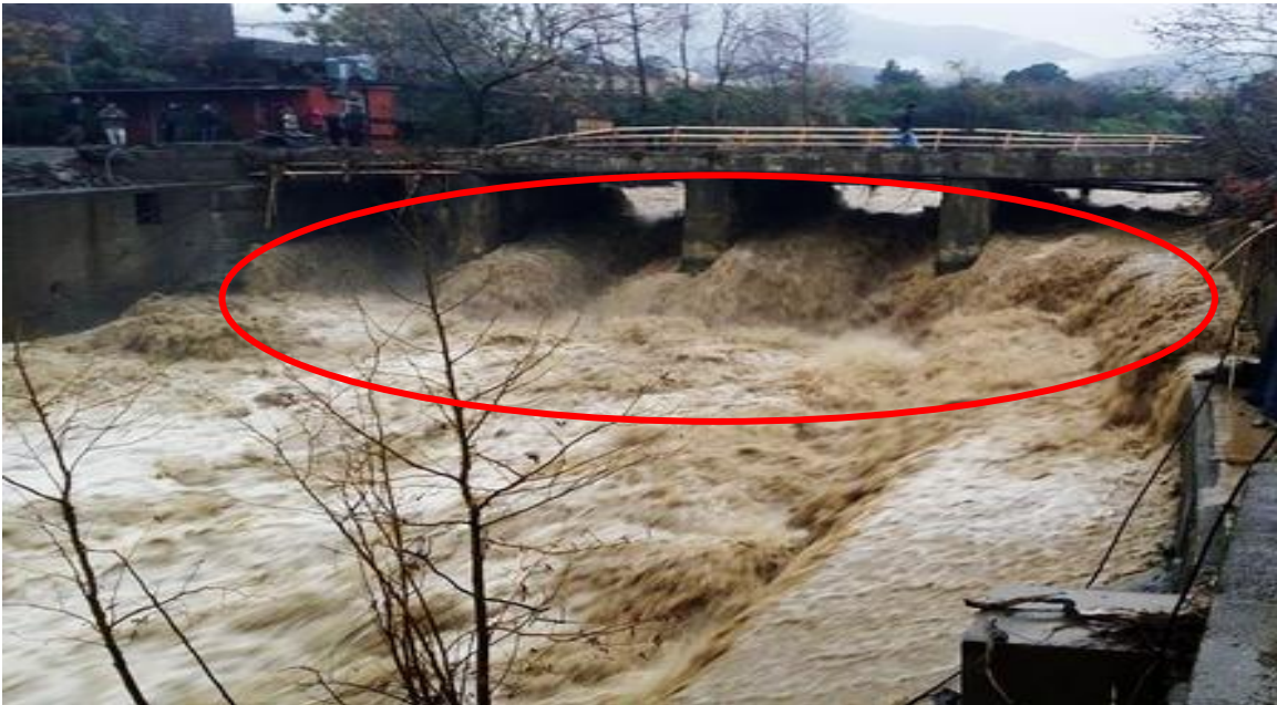
Resim 4.54. Arsuз ilçesi Höyük köprüsü taşkın anındaki görüntüsü
