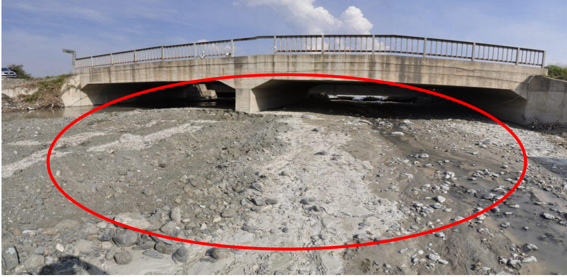
Resim 4.41 Payas ilçesi dere kesiti içerisinde rüsubat birikmesi
