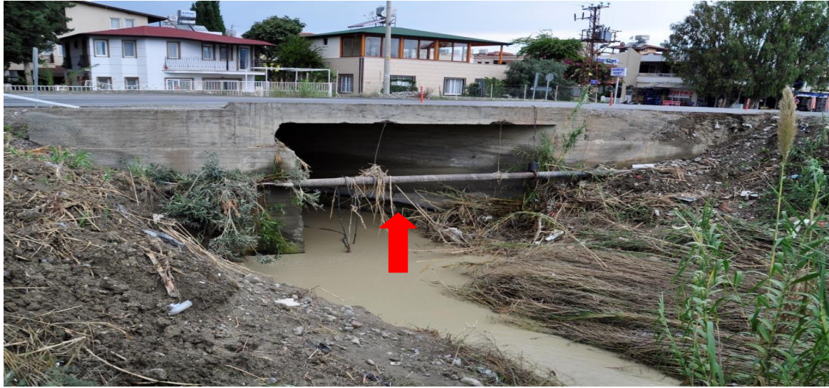
Resim 4.25. Arsuz ilçesi Soğanlık Deresi üzerinde kesiti daraltan içme suyu borusu
