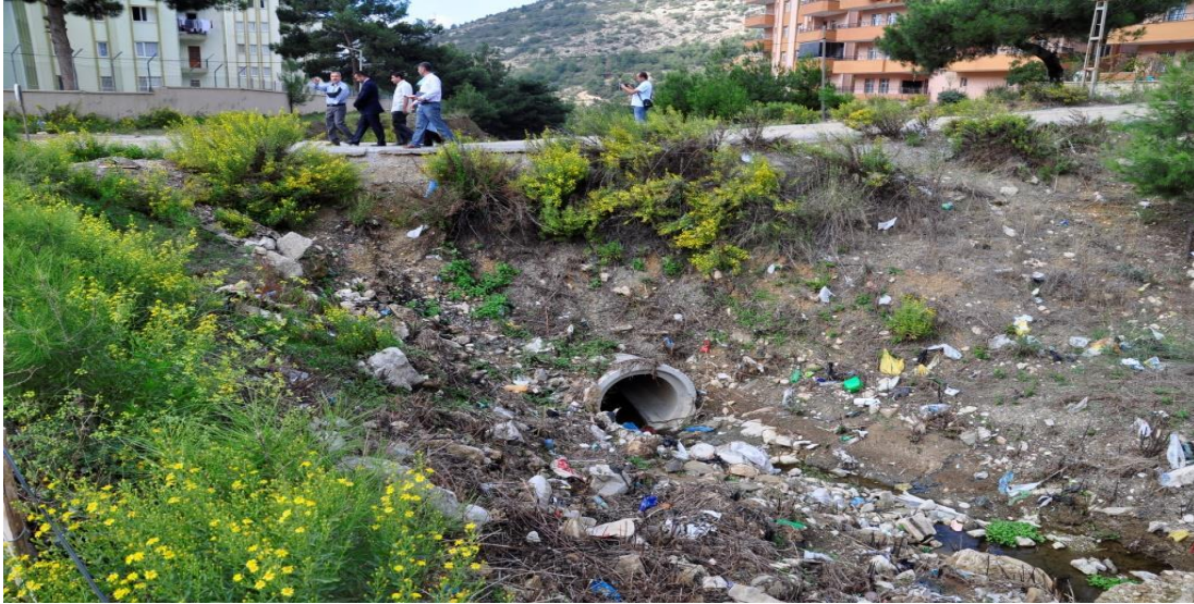
Resim 4.14. Belen ilçesi tekniğine uygun olmayan büz ve menfez yapıları
