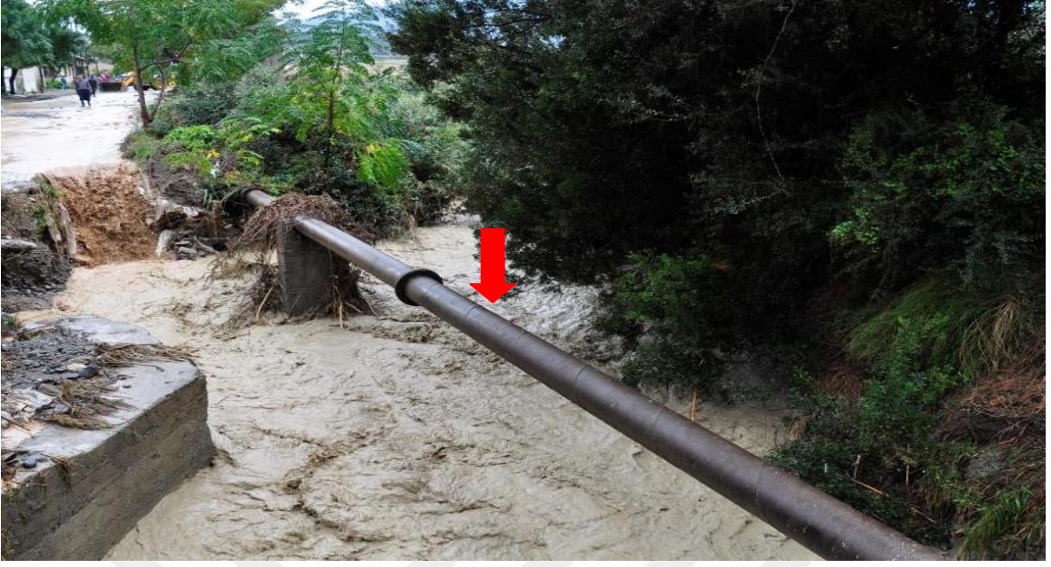
Resim 4.27. Arsuз ilçesi Madenli Deresi üzerinde kesiti daraltan içme suyu borusu
