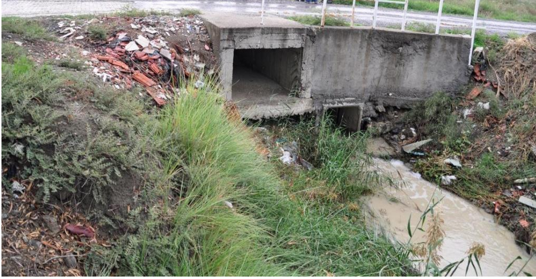
Resim 4.13. Arsuz ilçesi Gökmeşdan Deresi üzerinde tekniğine uygun olmayan menfez yapıları
