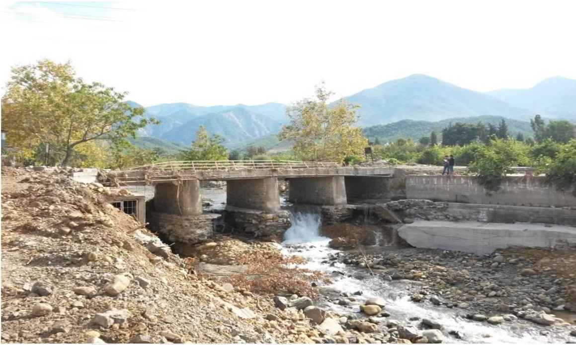
Resim 4.53. Arsuз ilçesi Höyük köprüsü yıkılma öncesi mansap kısmından görüntüsü
