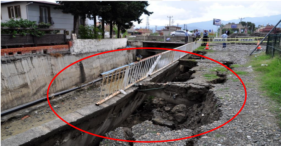
Resim 4.39. Arsuз ilçesi Sođanlık Deresi boyunca taşkın sonrasında meydana gelen hasar
