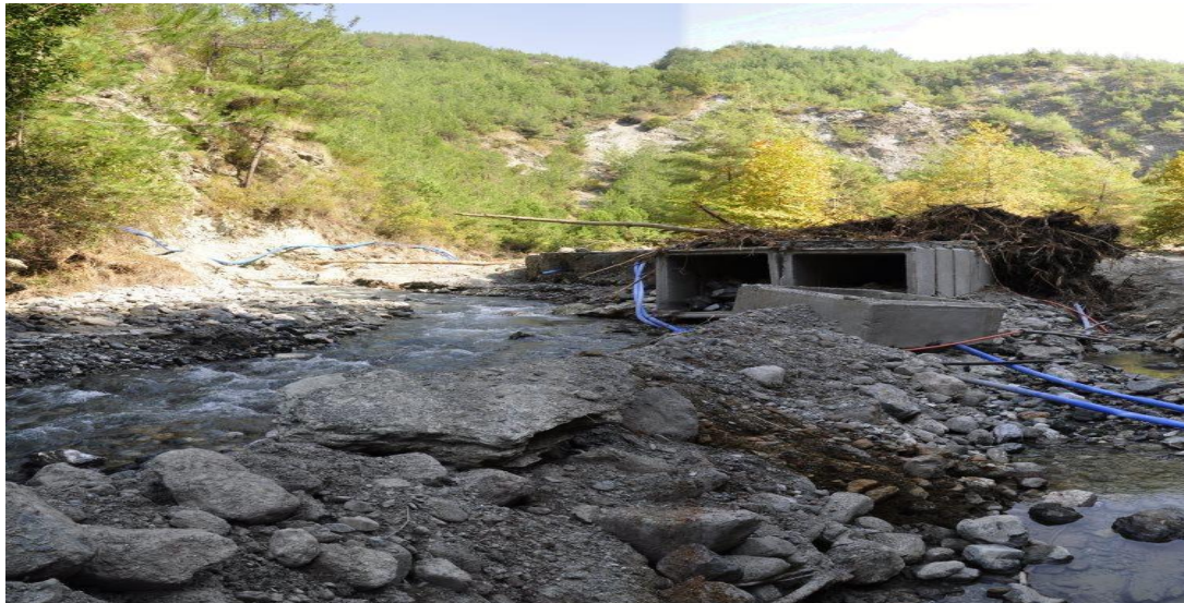
Resim 4.20. Erzincan ilçesi Sarıçay Deresi üzerinde hasar gören köprü
