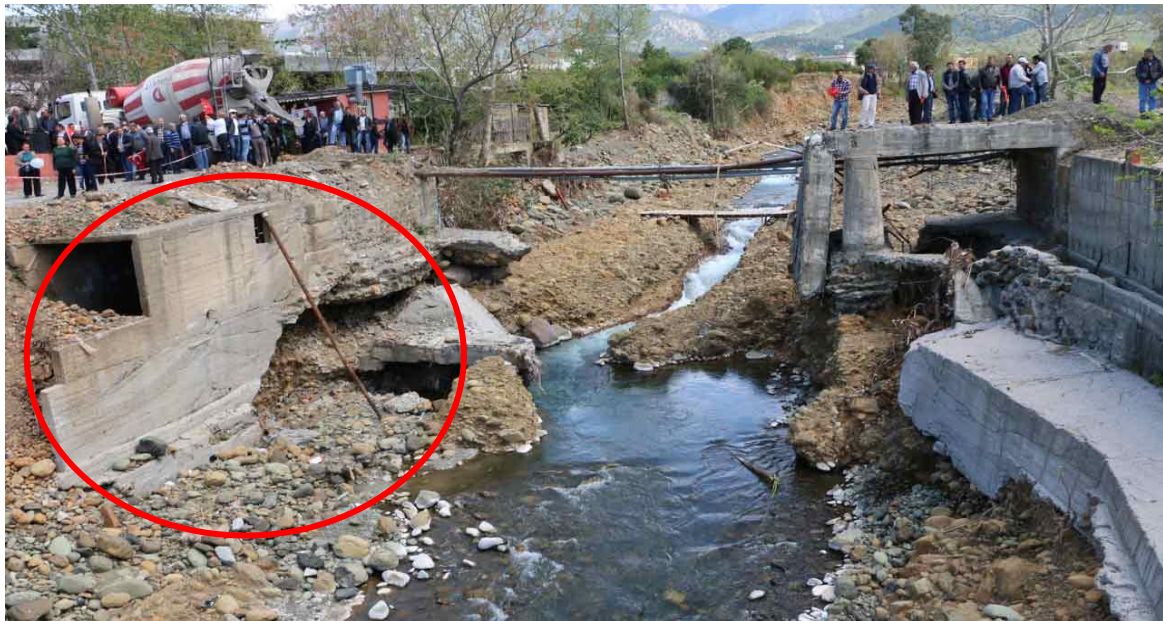
Resim 4.55. Arsuz ilçesi Höyük köprüsü taşkın sonrası yıkılmış görüntüsü
