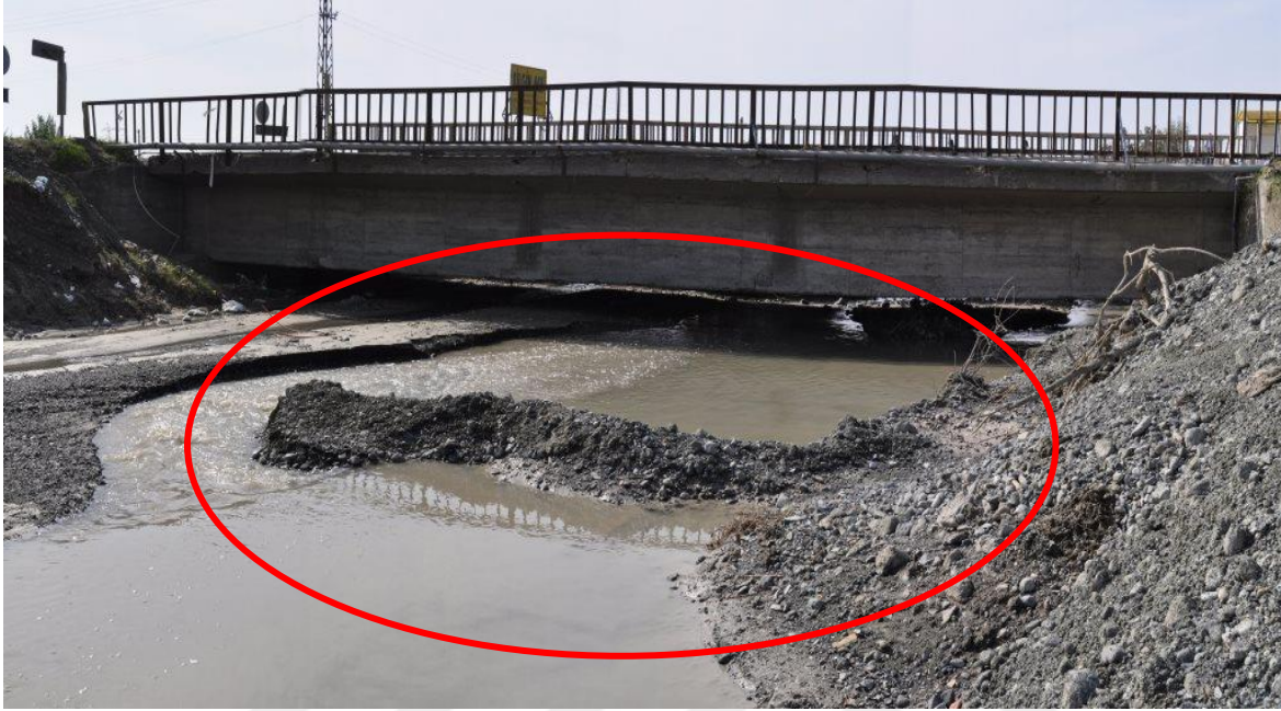
Resim 4.40. Dört yol-Adana eski karayolu üzerindeki köprü civarında rüsubat birikmesi
