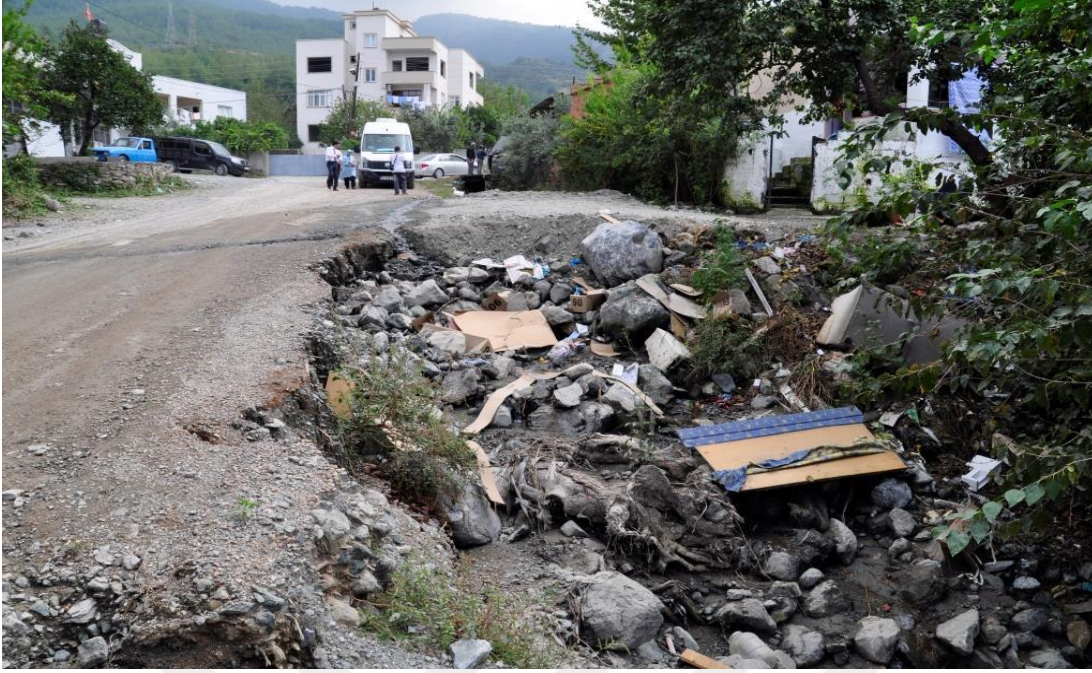
Resim 4.7. Dört Yol ilçesinde İlkbaharın Deresi kesiti içerisinde atılan evsel atıklar ile kesit kapatılması
