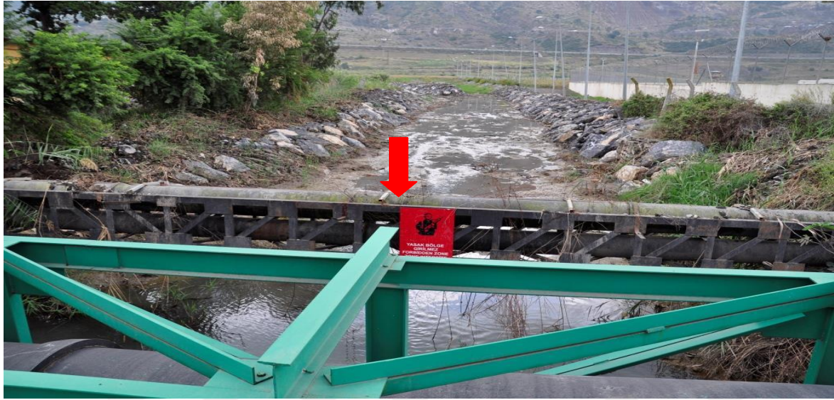
Resim 4.23. İskenderun ilçesi Yarikkaya Deresi üzerinde kesiti daraltan boru hattı
