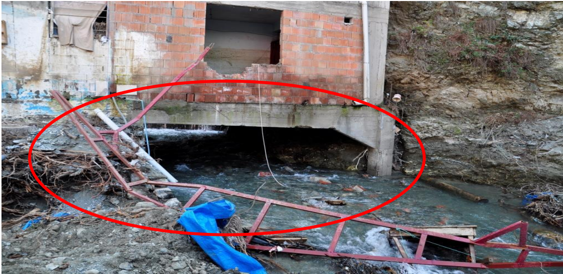
Resim 4.3. Erzin ilçesi Sarıçay Deresi üzerinde yapılan yapılar ve taşkın sonrası durumu
