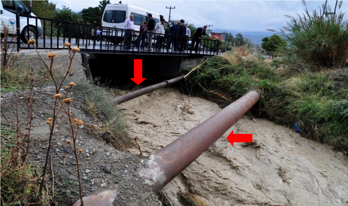
Resim 4.28. Arsuз ilçesi Madenli Deresi üzerinde kesiti daraltan içme suyu borusu ve taşkın anındaki etkisi
