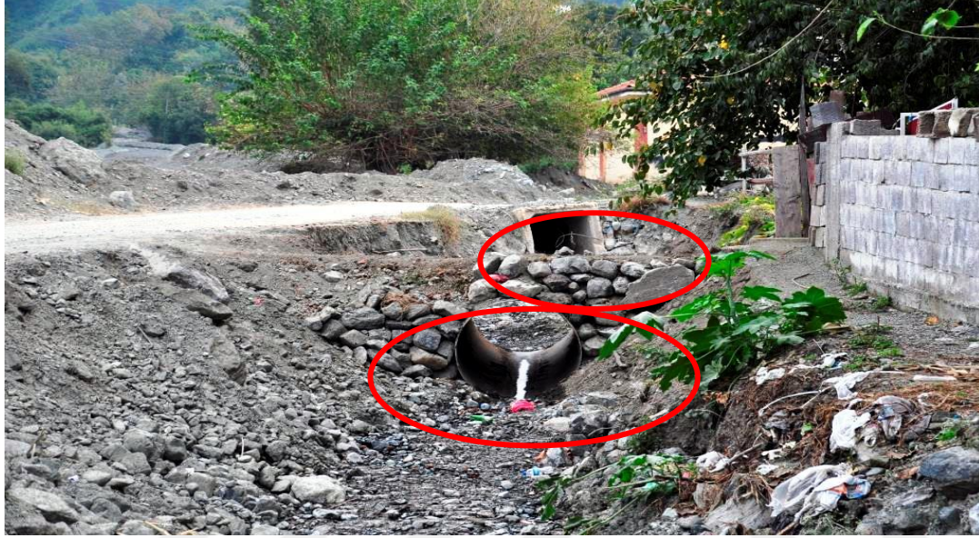
Resim 4.15. Arsuz ilçesi Üçgüllük Mahallesi Tekniğine uygun olmayan kesiti daraltan menfez
