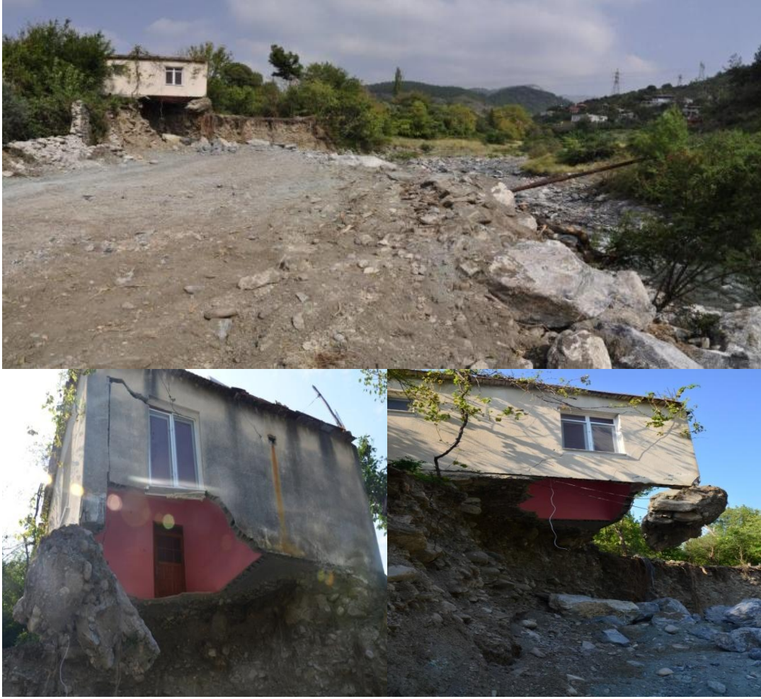
Resim 4.1. Dört yol ilçesi Özerli Çayı üzerinde dere içerisinde kalan ve hasar gören yapı
