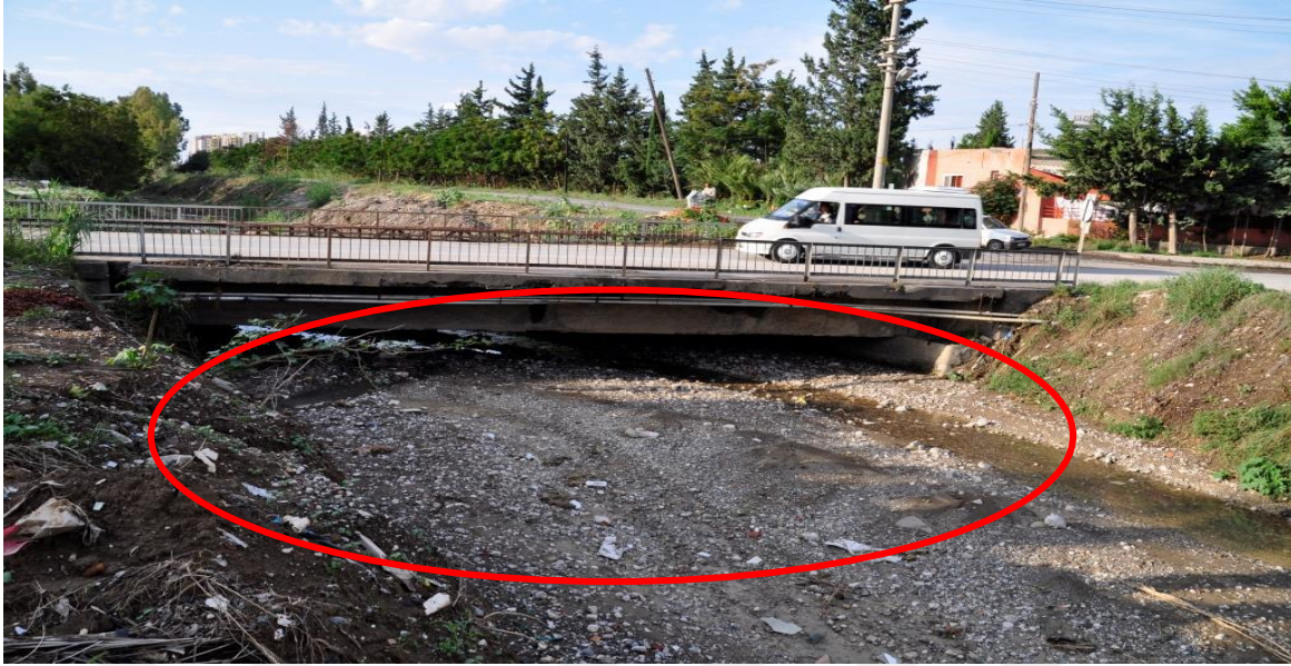
Resim 4.50. Arsuз ilçesi Şekere Deresi yatak temizlik yapılmadığı için kesit daralması
