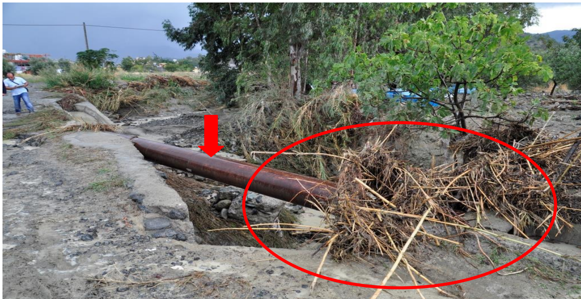
Resim 4.26. Arsuz ilçesi Üçgüllük Deresi üzerinde kesiti daraltan içme suyu borusu
