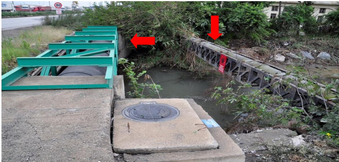
Resim 4.24. İskenderun ilçesi Yarikkaya Deresi üzerinde kesiti daraltan içme suyu ve boru hattı
