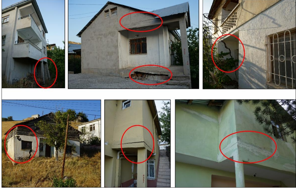
řekil 58: alıřma alanında tespit edilen yapısal hasar.
