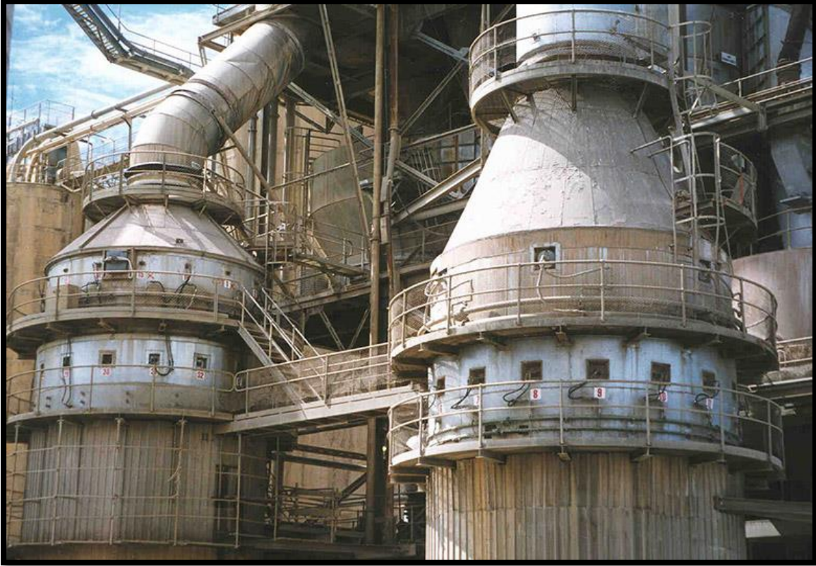
Şekil 2.8. Kuru tip gaz temizleme tesisi elektrofiltreleri (TAPC,2020)
