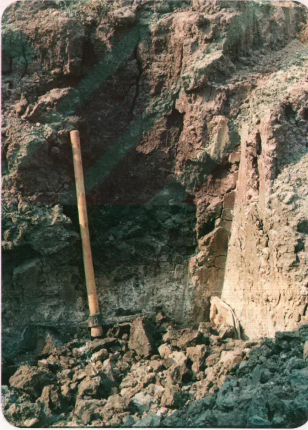
Şekil 48. Chromustertlerde Çatlakların Görünüşü (Osmanlı-Beyazköy).
