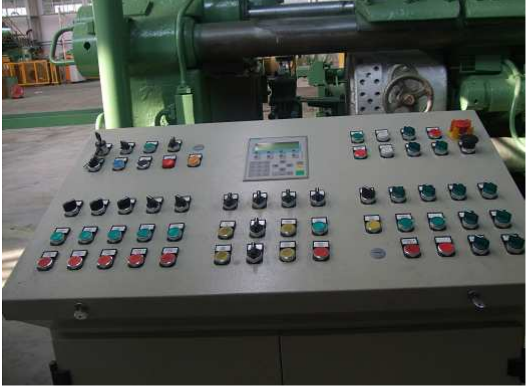
Şekil 4.5 Kumanda panosunun revizyon sonrası durumu
