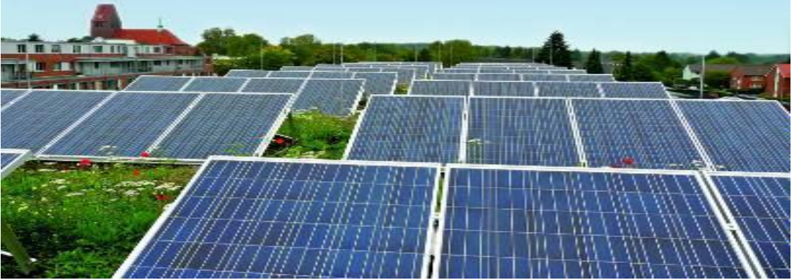
Şekil 4.1: Güneş panellerinin sehpa yerleşimi
