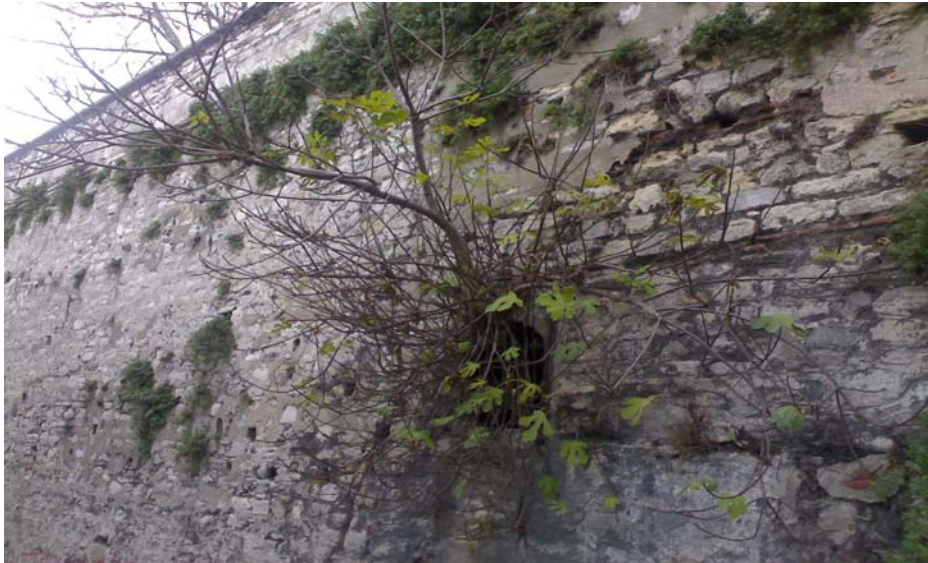
Şekil 4.16: Duvarlara Bitki Etkisi (İ.Ü. Beyazıt Kampüsü-İstanbul)
