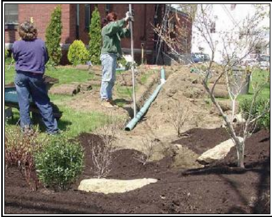
Şekil 2.46 Çatıdan gelen yağmur suyu plastik boru yardımıyla yağmur bahçesine yönlendirilmiştir (Anonim, 2005).
