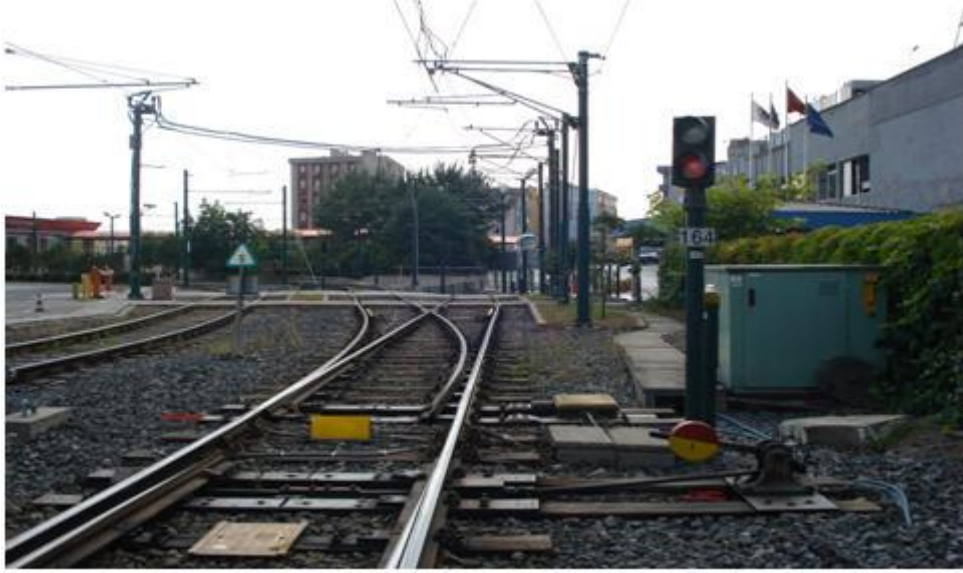
Şekil 2.2 Aksaray-Havalimanı Sinyalizasyon ekipmanları
