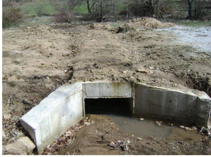
Şekil 2.24: Konumlandırma hatası yapılan menfezlerde tıkanma sorunu (Fotoğraf: GÖRMEZ)
