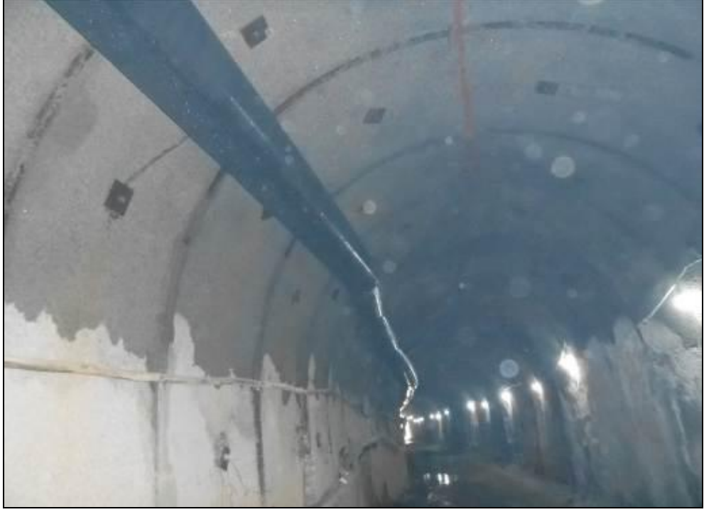
Şekil 4. 4 Tünel içindeki havalandırma sorununun fantüp ile çözümü
