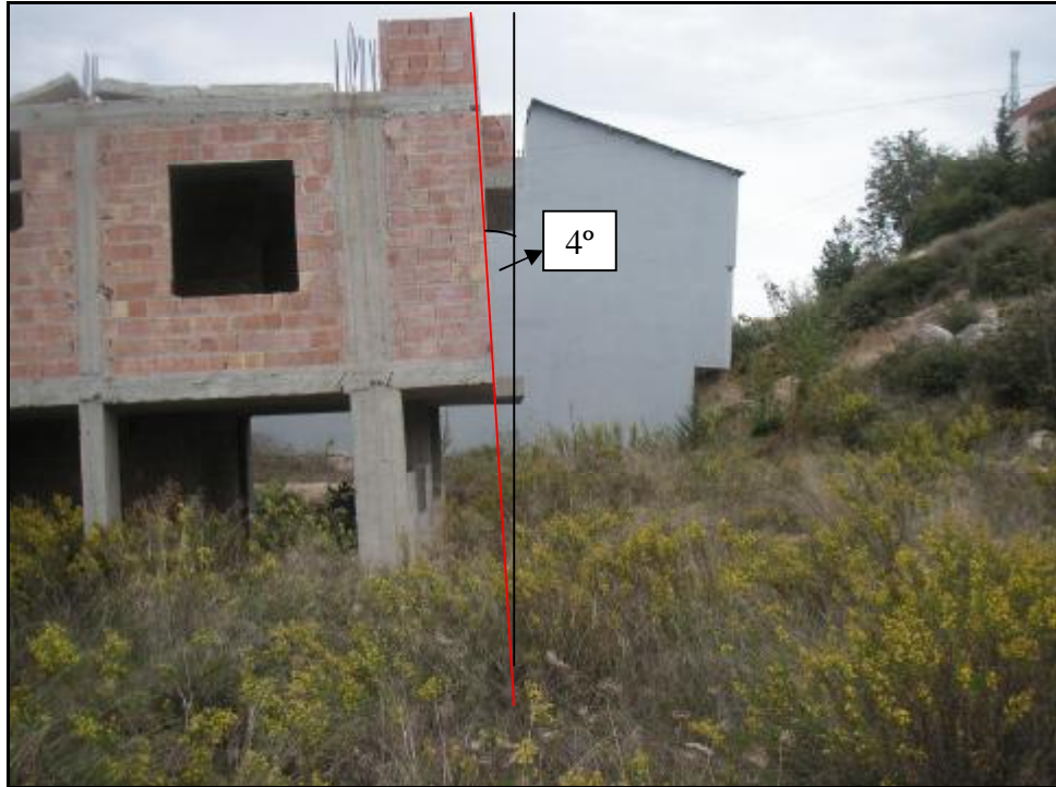
Şekil 1.3. Heyelan bölgesinde hasar gören bir yapı.
