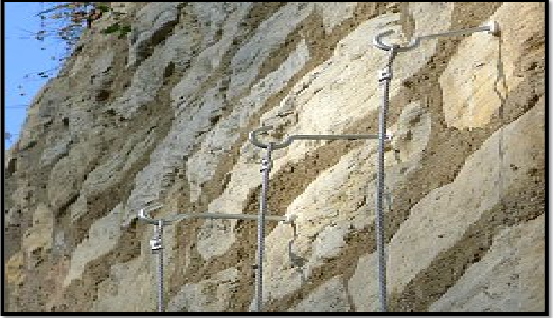
Şekil 2.36: Kablo ve Tel Örgü Ağ Sistemi Yeşil Cephelede duvardan uzakta dübele vidalı yeterince derin olmayan kanca 12 .
