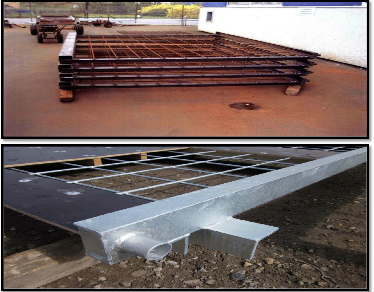
Şekil 3.8: Danimarka’da Kopenhag’daki Avrupa Çevre Ajansı Binasının Dış Mekan Dikey Bahçe Uygulamasında taşıyıcı profillere çelik vidalarla panel şeklindeki tel örgü tutturulması 33 .
