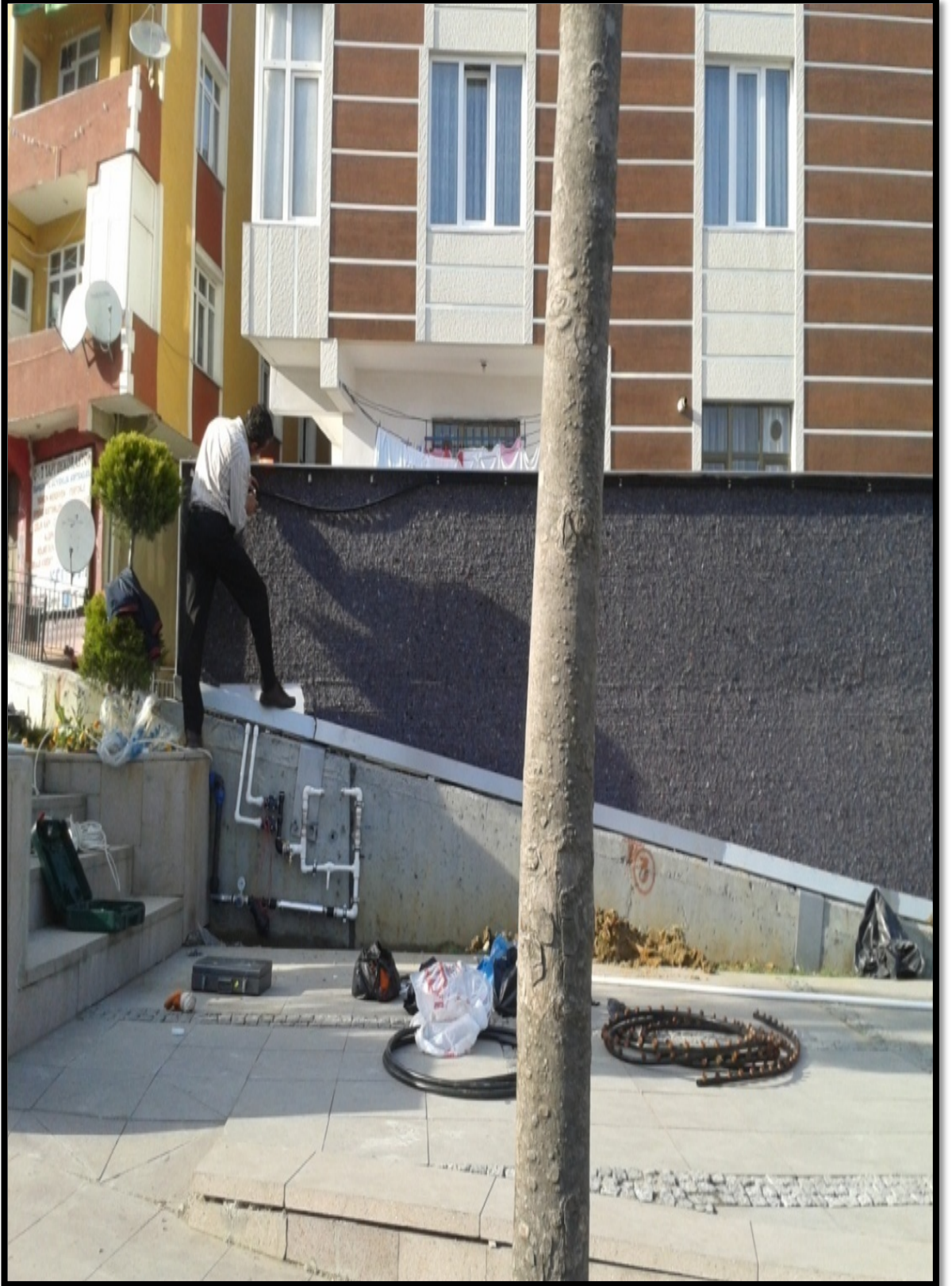
Şekil 4.18: Sultangazi Belediyesi Adem Yavuz Meydan Parkı Dış Mekan Dikey Bahçe Uygulamasında 1. kat keçe katmanının üzerine otomatik sulama sisteminin kurulması ve sulama borularının döşenmesi.
