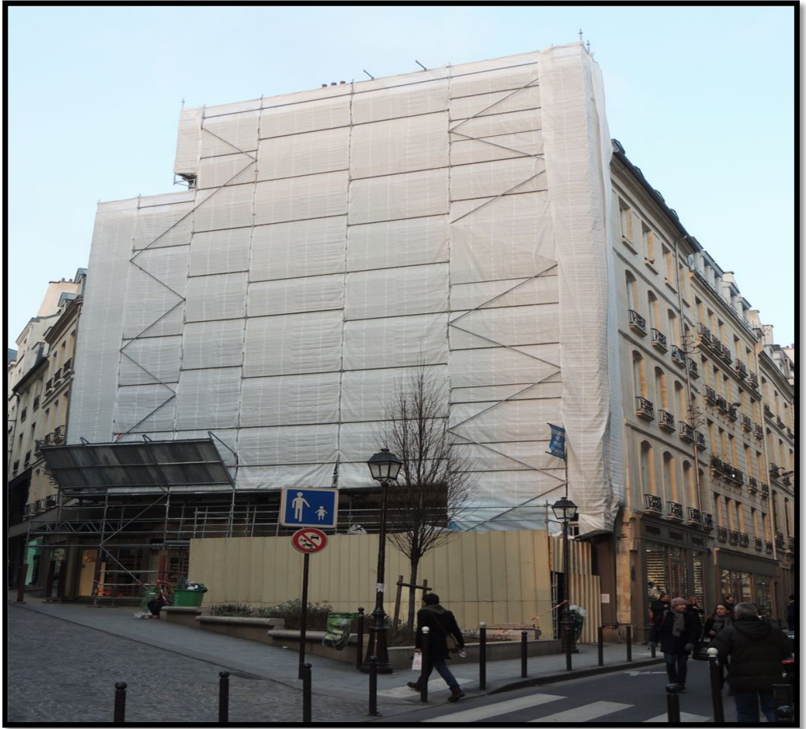
Şekil 3.21: l'oasis D'aboukir Dış Mekan Dikey Bahçe tesisi öncesi yapı iskelesinin kurulması ve jeotekstil keçe katmanları ile sulama hattının döşenmesi 34 .
