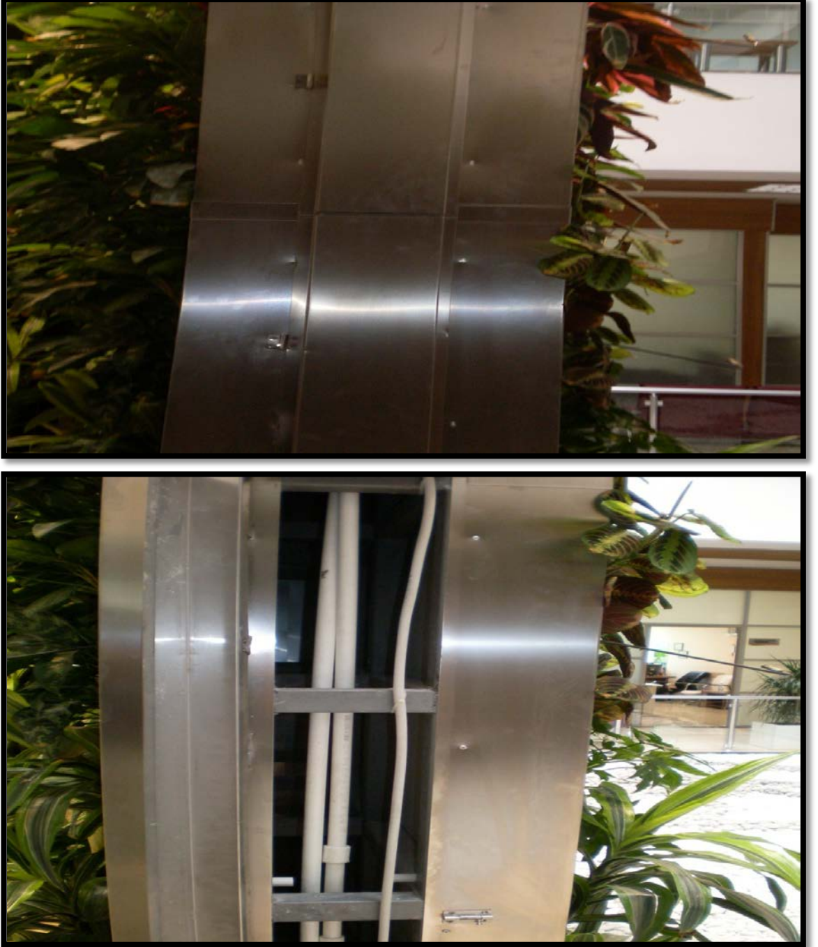
Şekil 3.56: Körfez Belediyesi İç Mekan Dikey Bahçe Uygulamasında galvaniz kaplama taşıyıcı kasa içerisinde sulama boruları ve aydınlatma sistemi kablosu.
