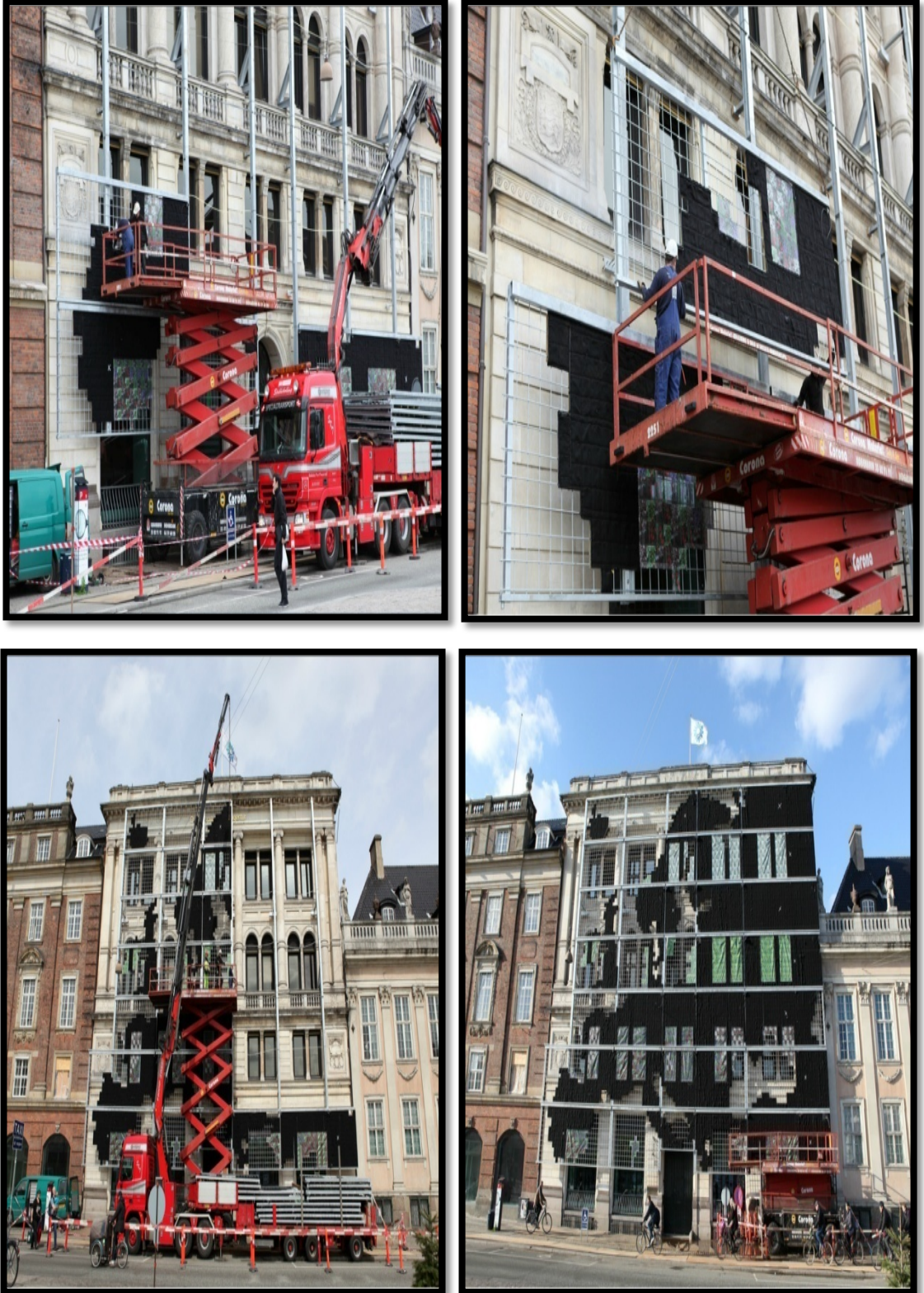
Şekil 3.9: Danimarka'da Kopenhag'daki Avrupa Çevre Ajansı Binasının Dış Mekan Dikey Bahçe Uygulamasında jeotekstil keçe katmanıyla birlikte Avrupa haritası şeklindeki dikey bahçe parça parça tesis edilmesi 33 .
