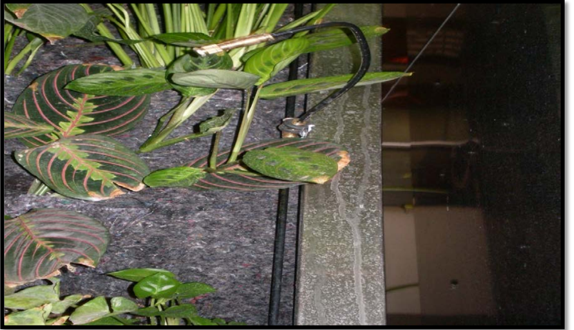
Şekil 3.58: Körfez Belediyesi İç Mekan Dikey Bahçe Uygulamasında sisleme sistemi.
