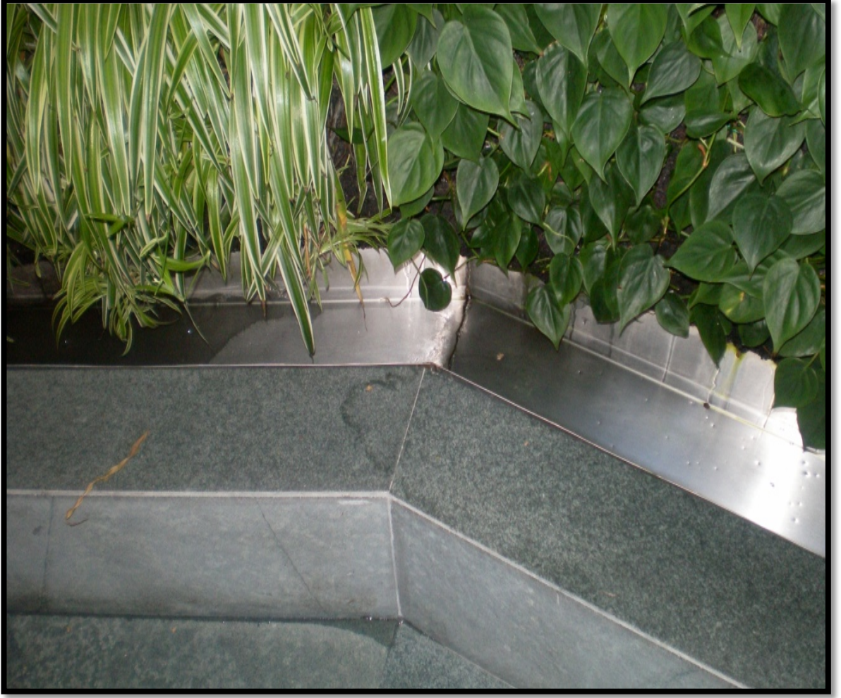
Şekil 3.102: Nuruosmaniye Armaggan AVM İç Mekan Dikey Bahçe Uygulamasında drenaj kanalı
