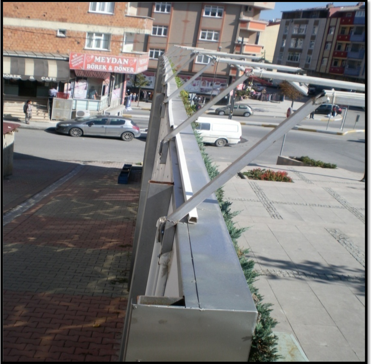
Şekil 4.31: Sultangazi Belediyesi Adem Yavuz Meydan Parkı Dış Mekan Dikey Bahçenin aydınlatma elemanları.
