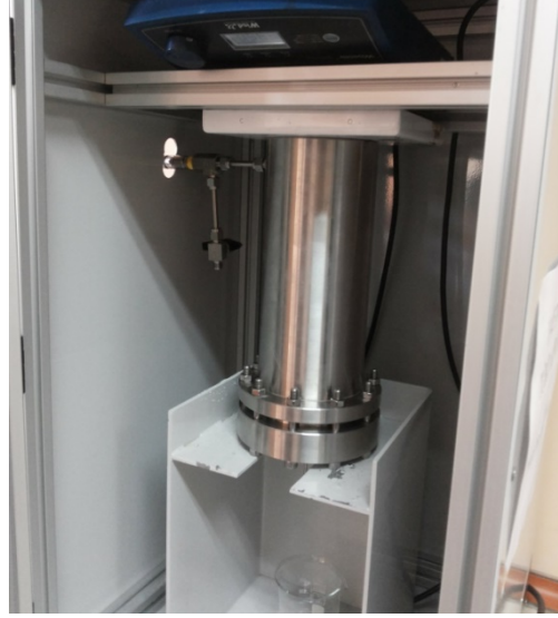
Şekil 3.10: Ev yapımı olarak yaptırılan Ters Osmoz sistemi.
