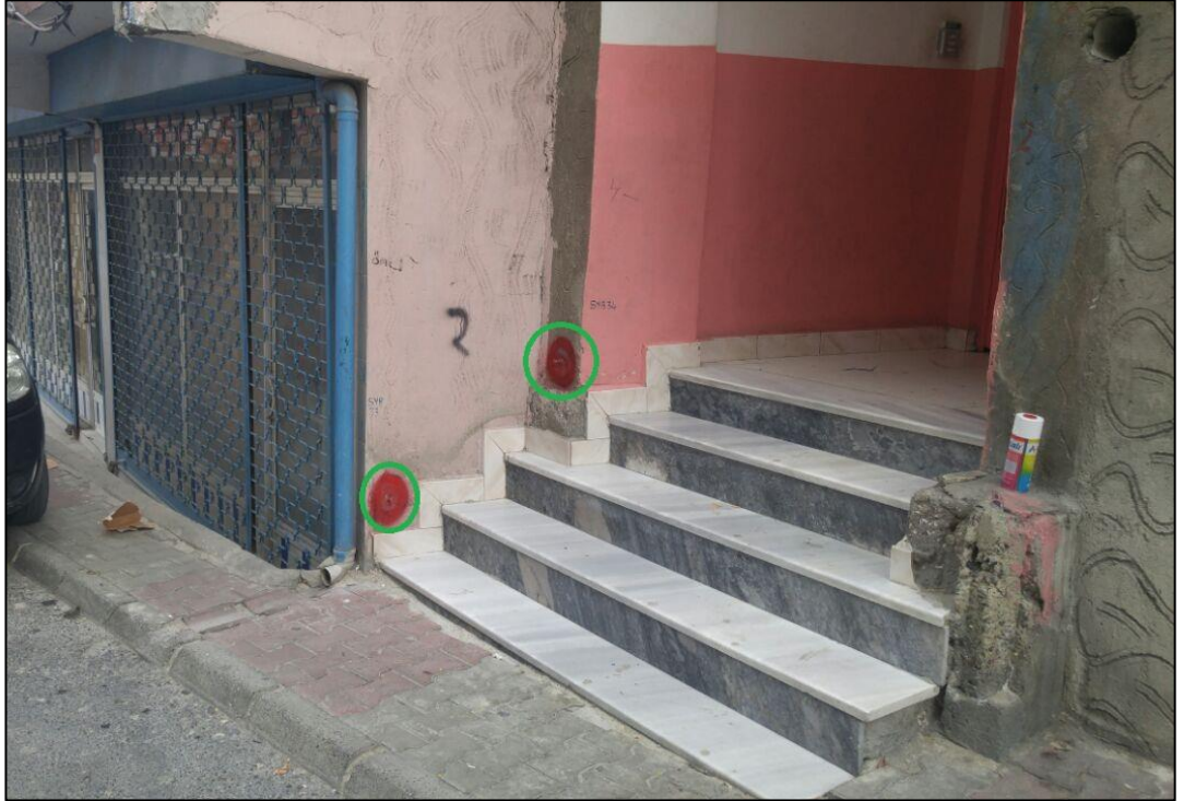
Şekil 3.3: Güzergah üzerinde mevcut bir binaya yerleştirilen bina oturma bulonu (BB).
