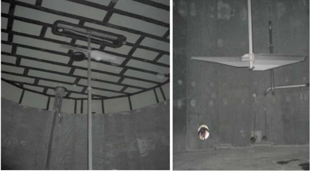
Şekil 3.8. Katı atık ayırma tesisi anaerobik çürütücünün iç kısmı (Sobacken)
