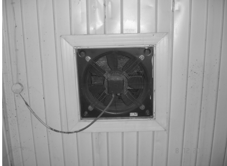
Şekil 4.3. Sarartma Odalarında Kullanılan Havalandırma Fanı
