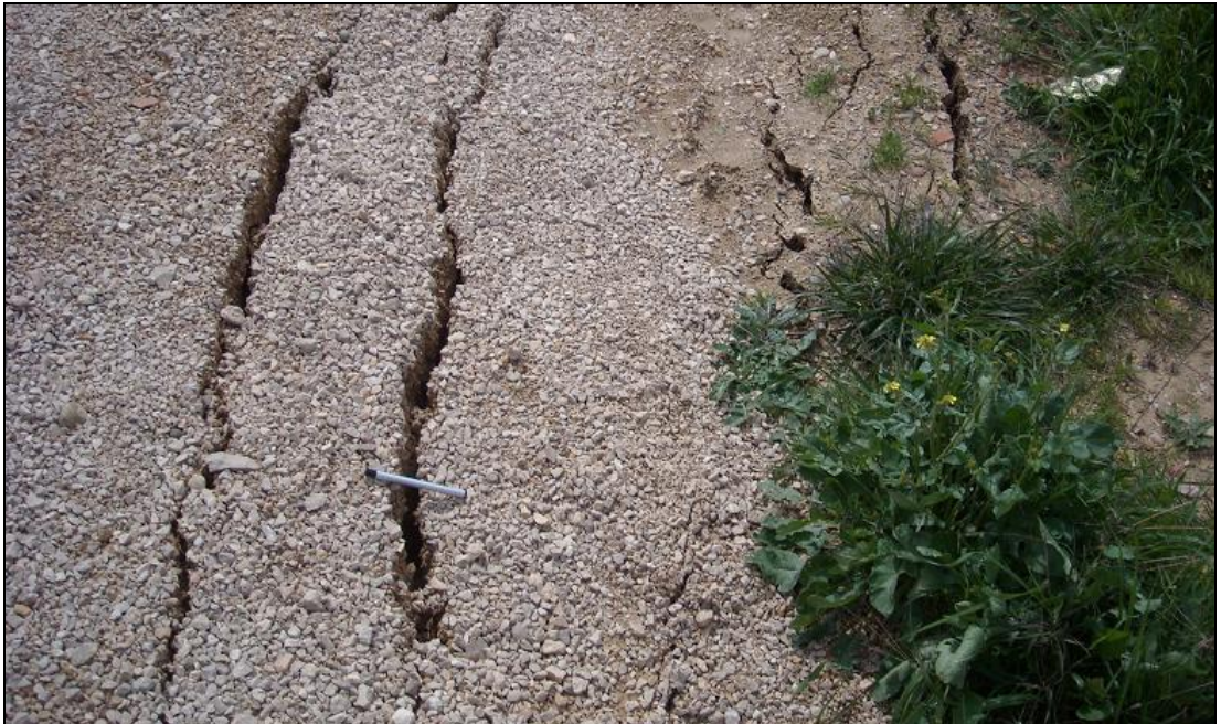
Şekil 4.57. Heyelan etkisiyle gelişen gerilme çatlakları
