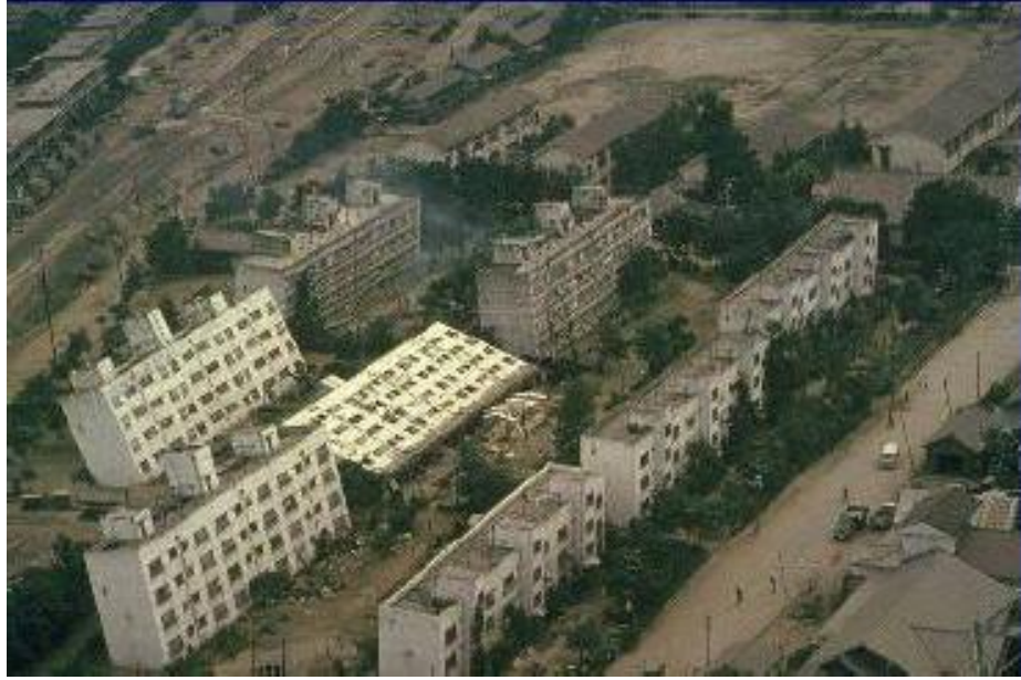
Şekil 5.1. Niigata (1964) Depremi Sonrası
