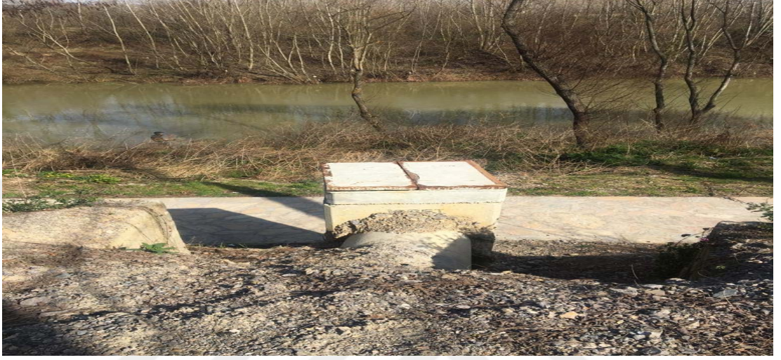
Resim 4.26 : Okulak Mahallesi'nde Irmađa Akıtılan Bir Kanalizasyon Őebekesi.
