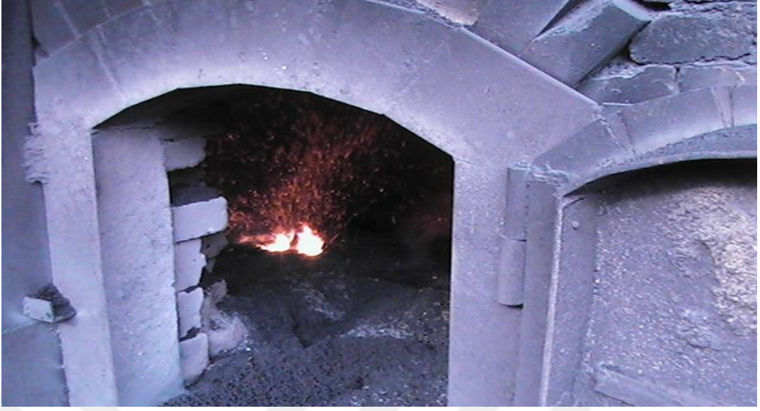
Şekil 4.33: Kurutma –cehennemlik bölümü.
