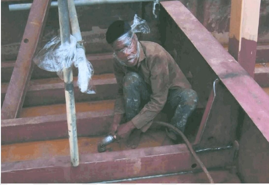
Şekil 2.5: Koruyucu donanımın uygun olmaması örneği (İsgfrm, 2017).
