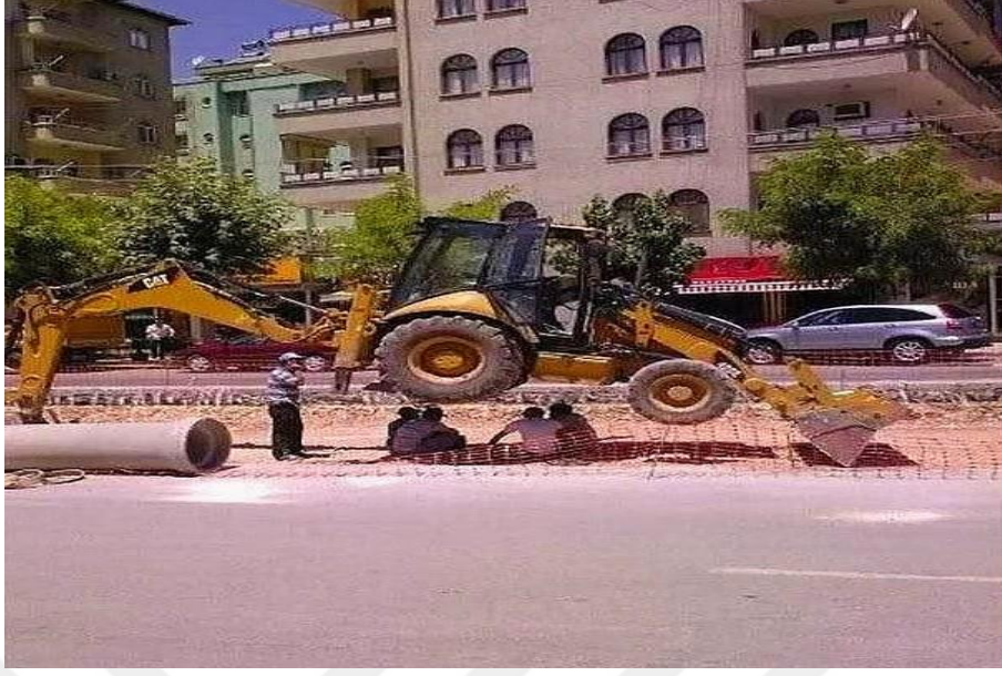
Şekil 2.1: Tehlikeli davranış örneği (İsgfrm, 2017).
