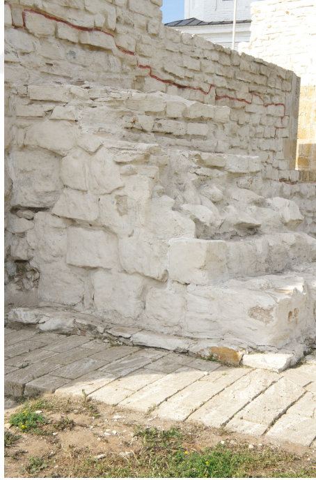
F.72 Büyük Caminin Doğu duvarındaki payanda kalıntısı.
