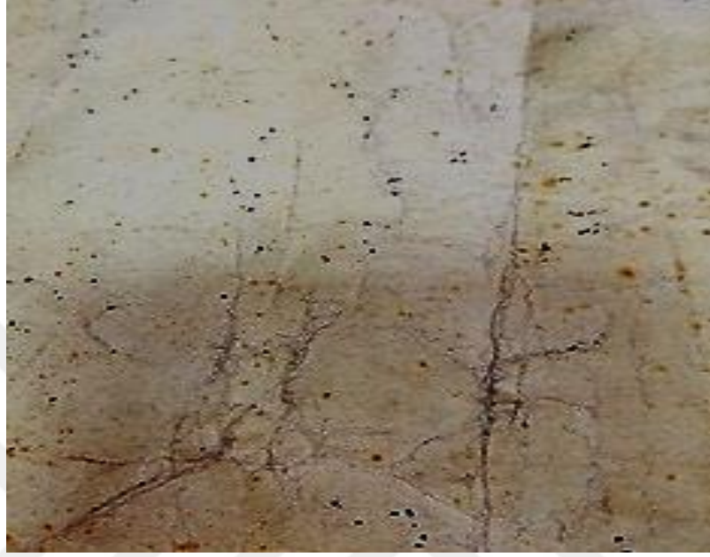
Fotoğraf 3.12 : Çatlaklar (Alyasin, 2019 ).
